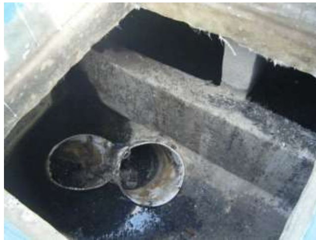
Figura 29. Tubería de conducción del pretratamiento al tratamiento primario
