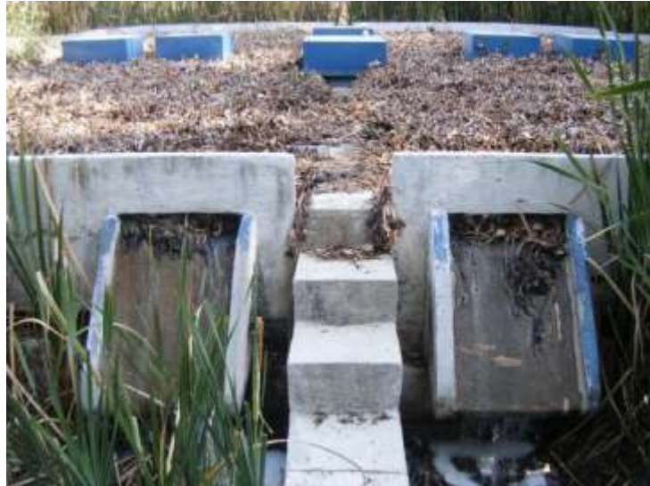
Figura 10. Vertido del agua a tratar al sistema de humedales de tule
