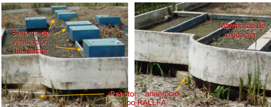
Figuras 7 y 8. Detalle del reactor biológico tipo RALLFA, así como su sistema de ventilación en la losa superior y mamparas de oxidación.
