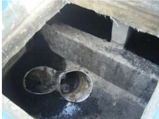
Figura 6. Tuberías de salida del pretratamiento al reactor biológico
