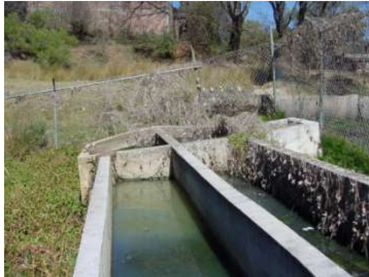
Figura 4. Fotografía del estado actual del pretratamiento. Nótese el grado de inestabilidad de la estructura la cual presenta un deslizamiento sumamente considerable, apreciable en el espejo de agua.
