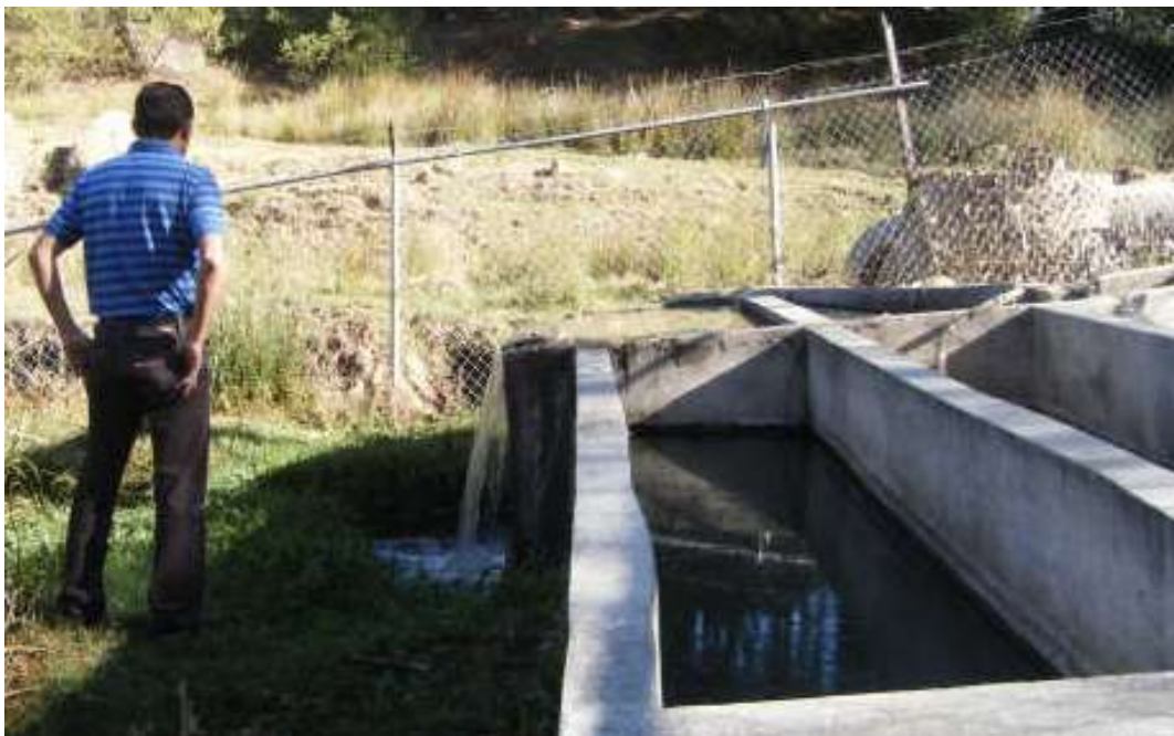
Figura 28. Detalle del desbordamiento de las aguas residuales por insuficiencia hidráulica.
