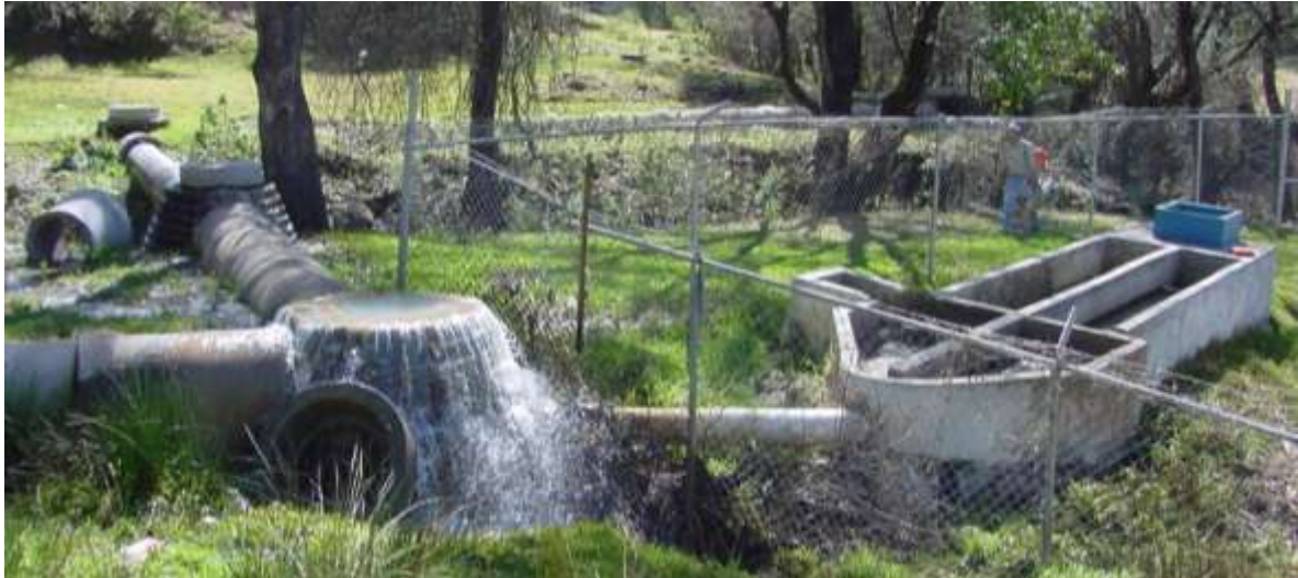
Figura 5. Detalle de la llegada de aguas residuales al pretratamiento, 2 colectores de 76 cm interconectados a pozo de visita, con descarga insuficiente a pretratamiento con tubería de 25 cm.
