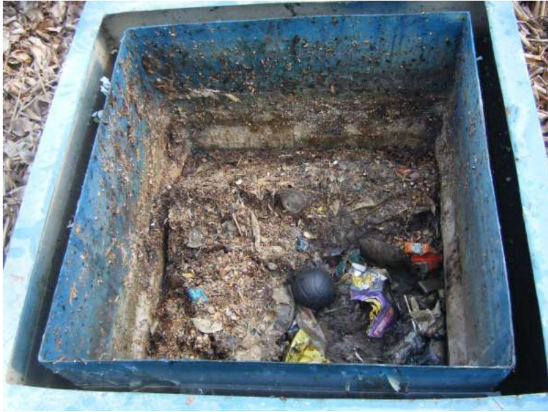
Figura 9. Vista al interior del reactor biológico en una de sus ventilas, donde se observa saturación de sólidos gruesos por ineficiencia en el pretratamiento
