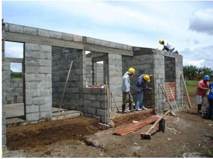
IMAGEN IV-11: CASA CONSTRUIDA CON MATERIALES DE MALA CALIDAD
