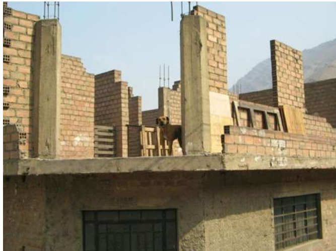
IMAGEN IV-5: CASA MAL TERMINADA
