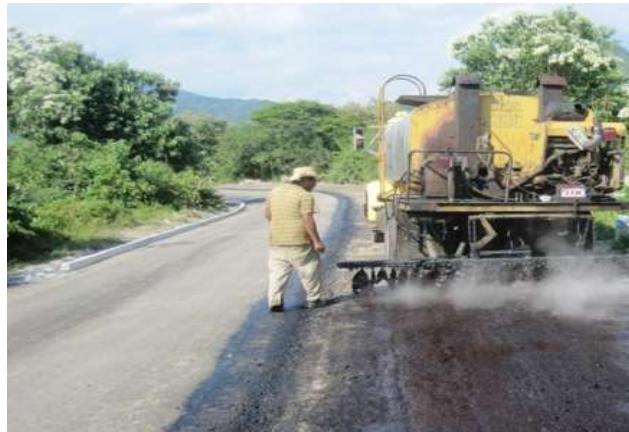
Figura 4.39. Riego de liga sobre capa de base hidráulica para recibir carpeta asfáltica.
