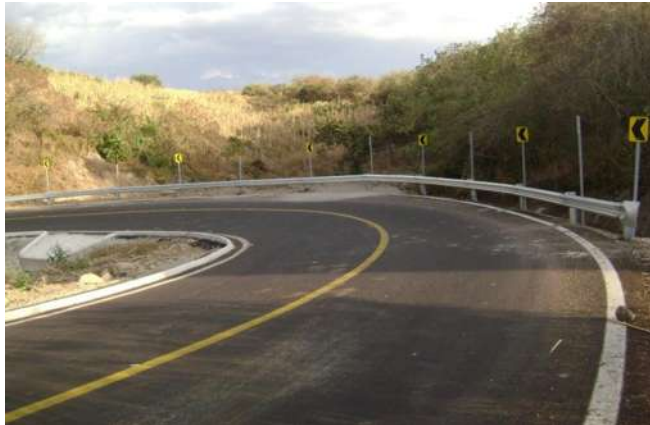
Figura 4.54. Señalamiento horizontal y vertical (OD-12 y Defensa metálica).
