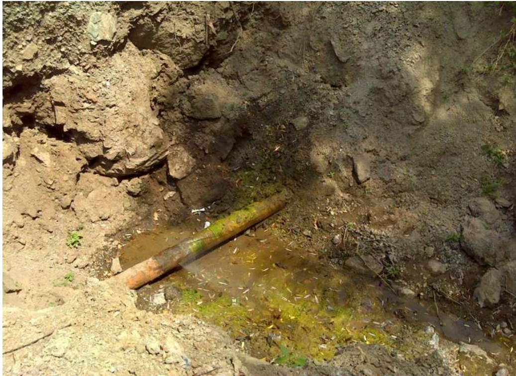
Imagen 8. Línea de bombeo.
