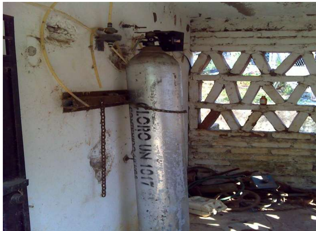
Imagen 10. Sistema de cloración actual.
