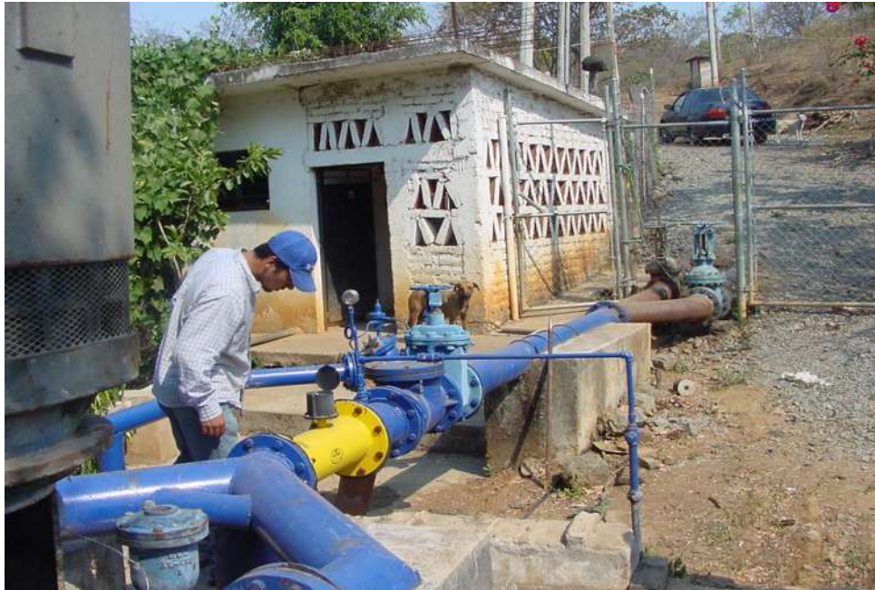
Imagen 6. Cárcamo de rebombeo.
