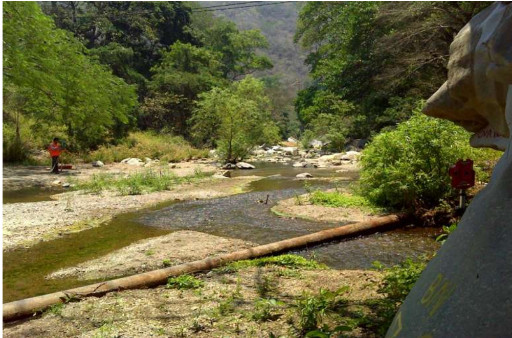
Imagen 5. Línea de bombeo existente.
