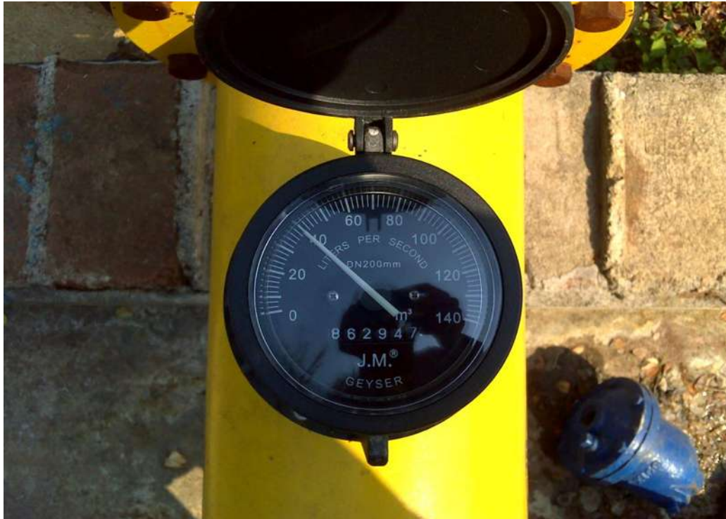
Imagen 11. Gasto de bombeo actual.
