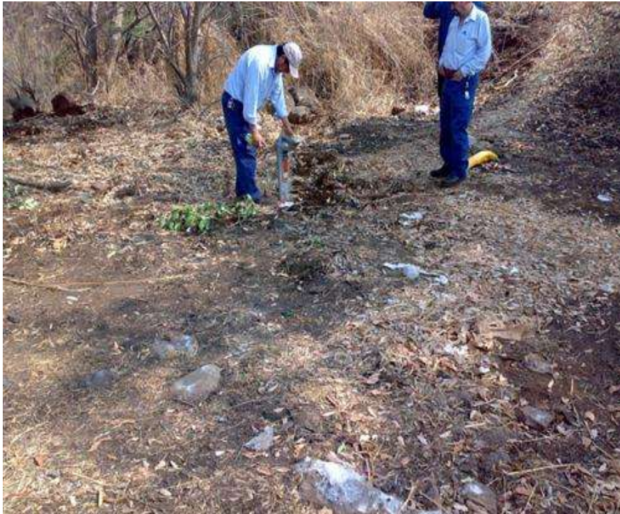
Figura 50. Localización de la línea de fibra óptica.
