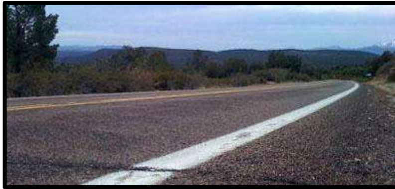
Figura 3. Agrietamiento por baja temperatura.
