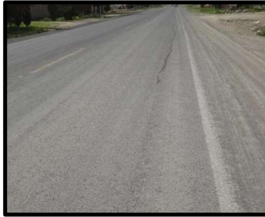
Figura 4. Fisuración moderada por fatiga.
