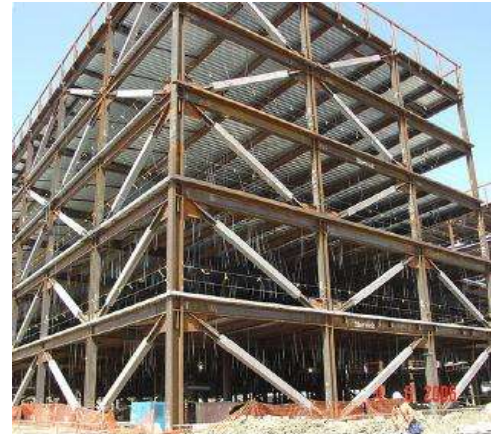
Fig. 2.1.2.c.1 Edificio de acero con riostras de pandeo restringido.
