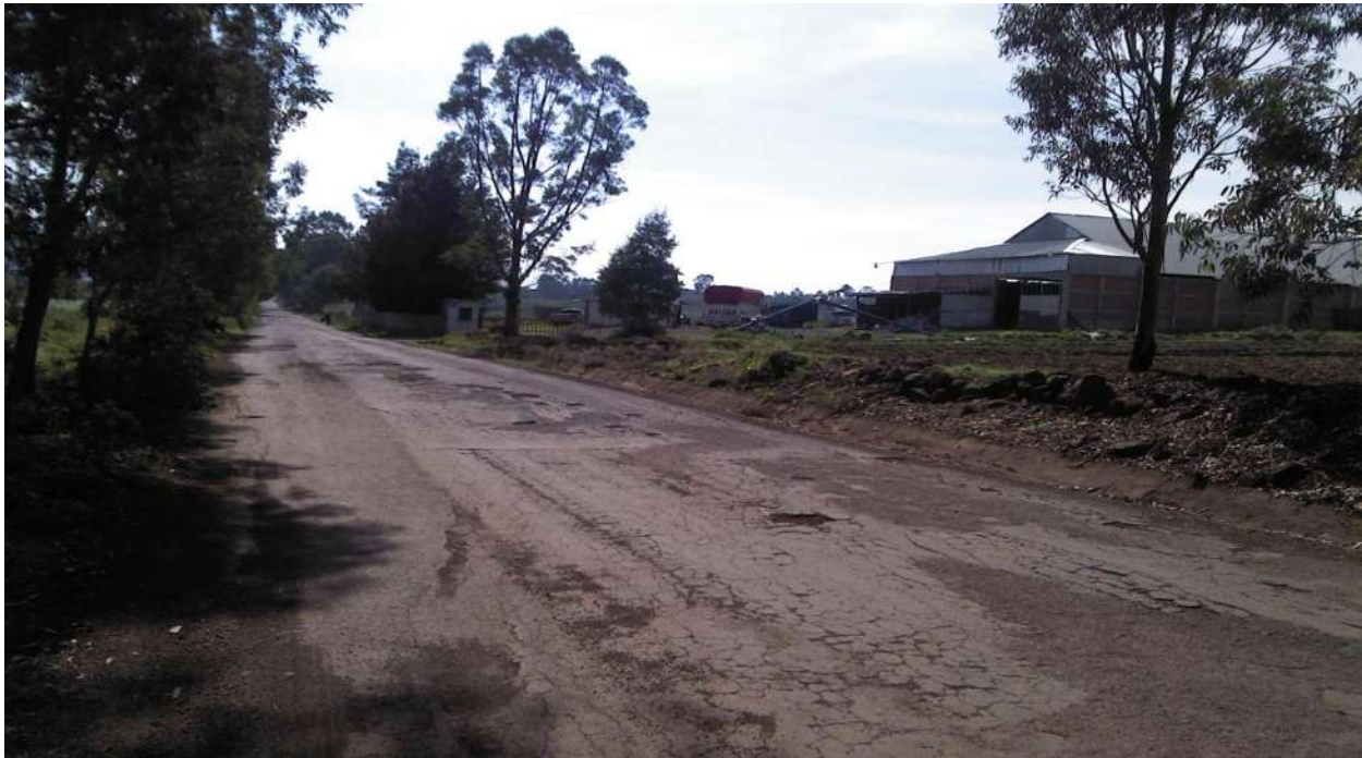
FIG. 4.2 CARPETA CON DEFORMACIONES IMPORTANTES Y CUNETAS EN MAL ESTADO
