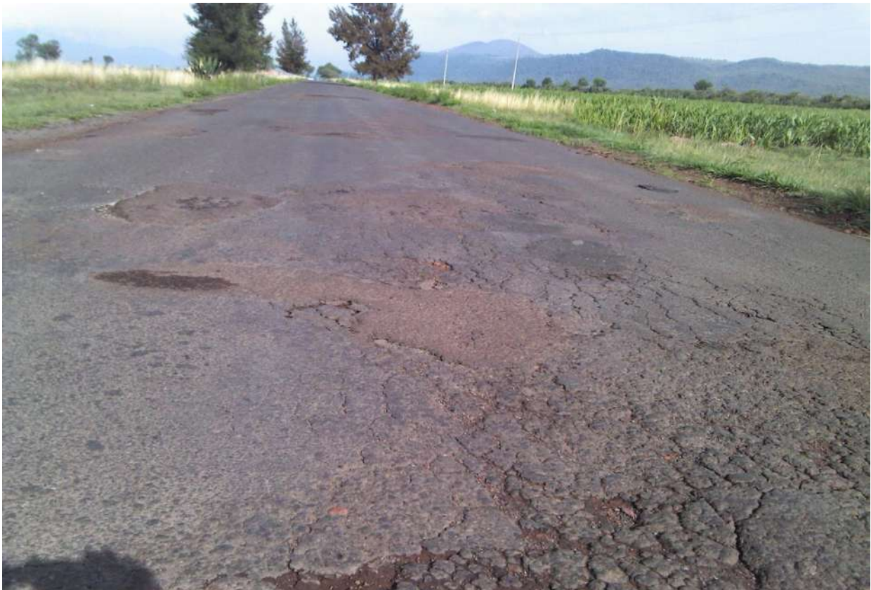
FIG. 4.1 CARPETA CON UN DETERIORO SEVERO
