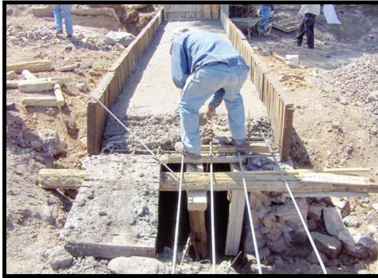
Fig. 3.14 ACERO DE REFUERZO
