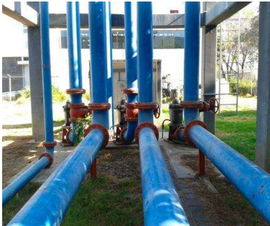
Figura 4. Equipo de bombeo que alimenta al tanque de carga constante
