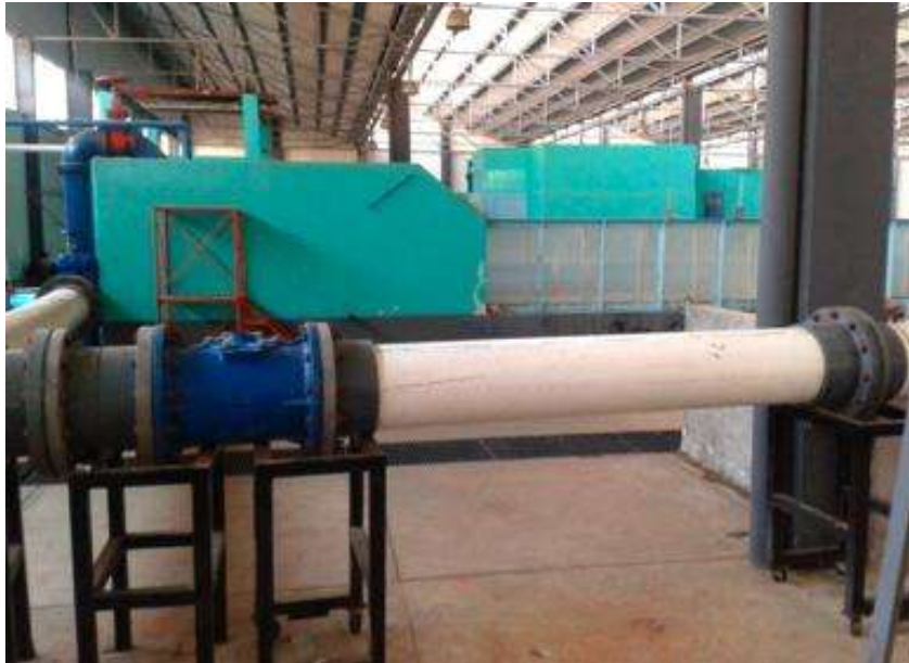
Figura 7. Conexión del tramo de medición
