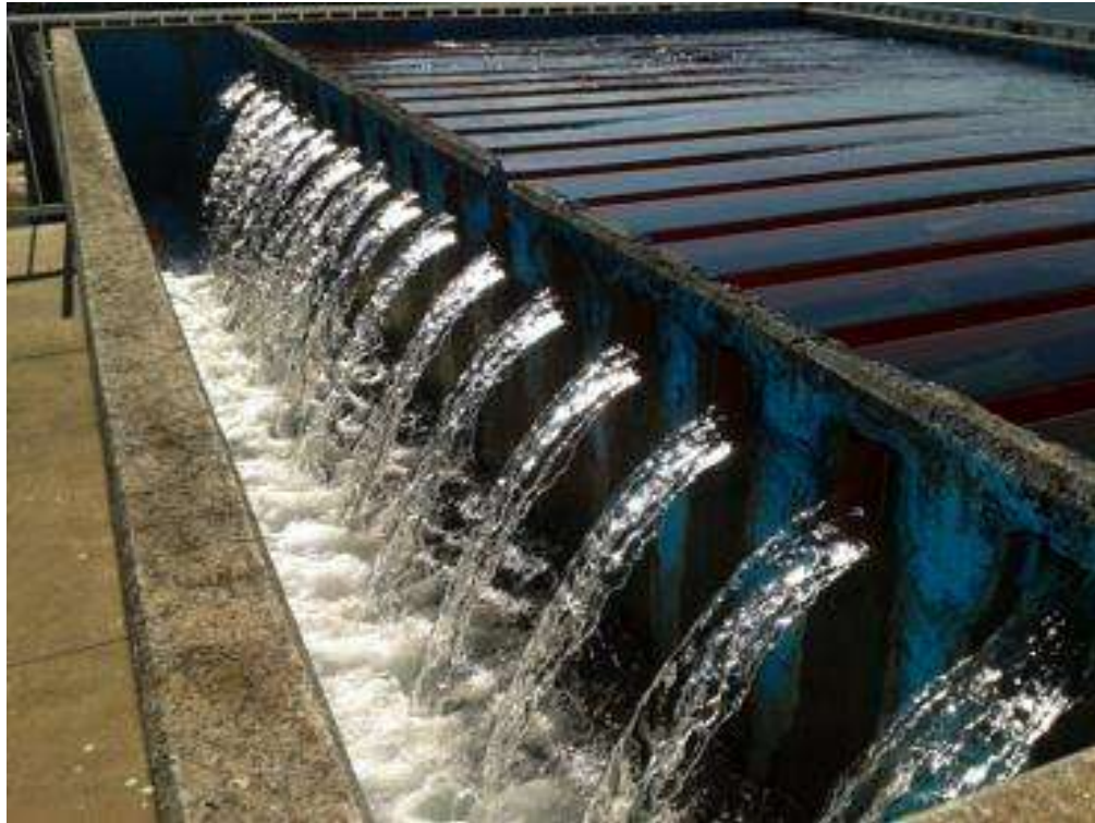
Figura 5. Tanque de carga constante ubicado a 8 m de altura
