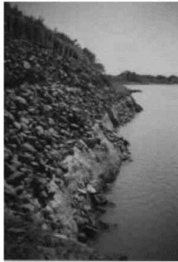
Figura 2.21 Protección colapsada de la defensa de Cayastá relevada en el año 2001.
