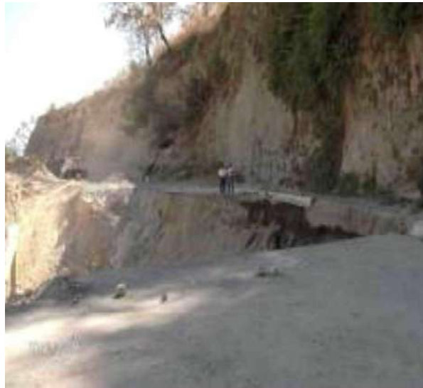
Figura 2.25 Imagen de la carretera Tetela del Volcán – La Espada, antes de la obra.
