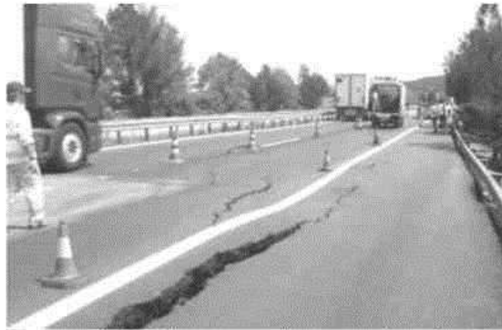
Figura 2.13 Grietas y escalones previos a la rotura completa del terraplén.
