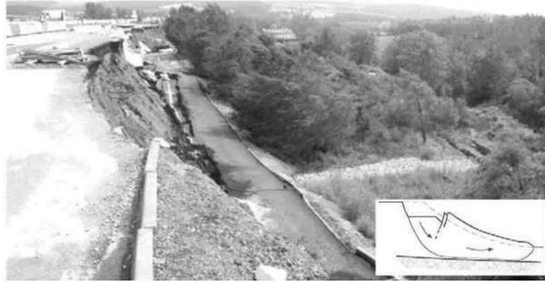
Figura 2.14 Panorámica parcial del deslizamiento y esquema de forma de rotura.
