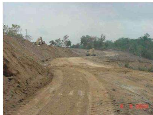
Figura 2.23 Construcción de un talud de 45° de inclinación y terraza de 20.0 m de ancho, mayo de 2003.
