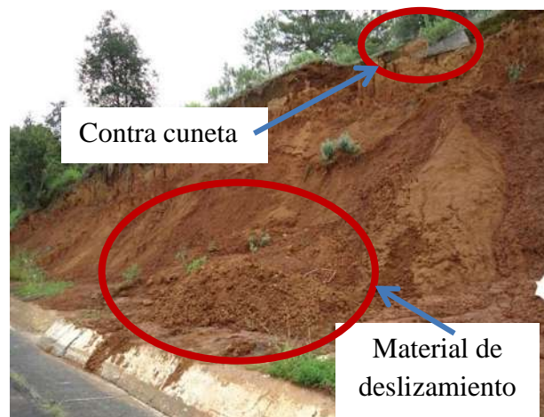
Figura 2.32 Deslizamiento de talud en la autopista Pátzcuaro – Uruapan, zona de estudio.
