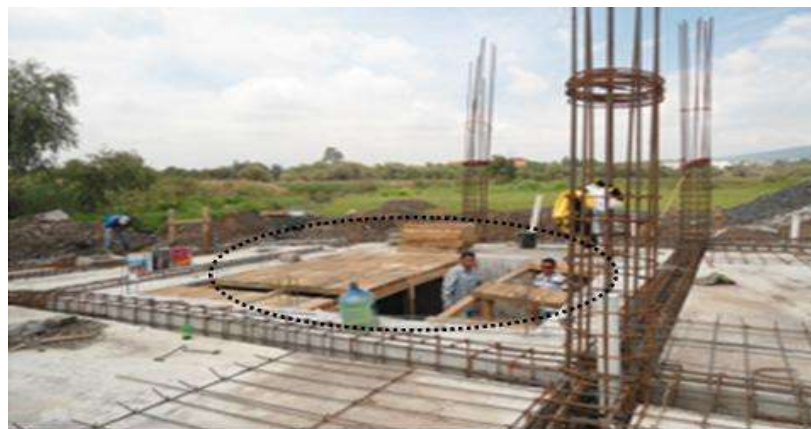
Fig. 5.12 Cisterna para agua.
