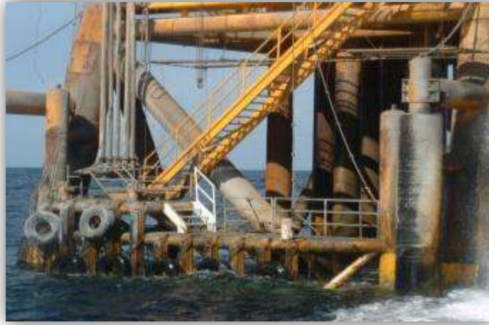
FIGURA 2.17. EMBARCADERO EN PLATAFORMA DE PERFORACIÓN
