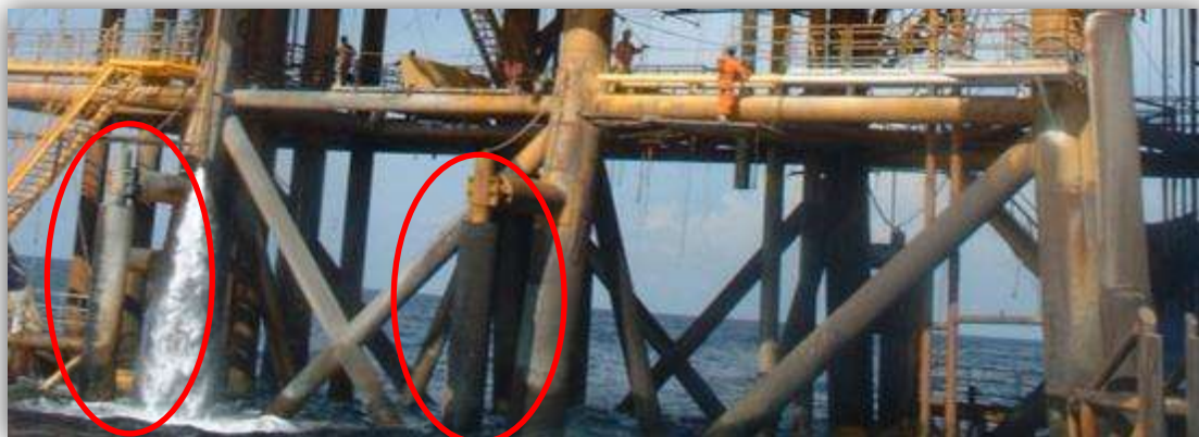
FIGURA 2.16. DEFENSAS PARA PROTECCIÓN DE POSIBLES IMPACTOS SOBRE LA ESTRUCTURA
