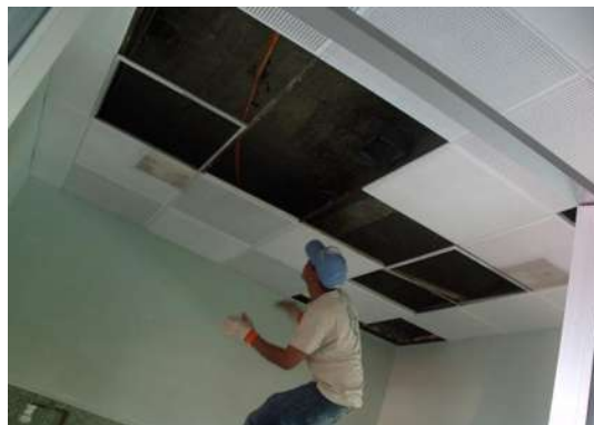
IMAGEN 51.- PLAFÓN REGISTRABLE EN ALGUNAS ÁREAS DE QUIRÓFANOS.
