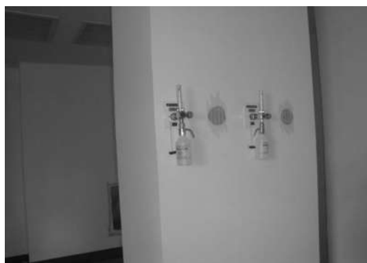
IMAGEN 243.- TOMAS DE OXÍGENO Y AIRE EN QUIRÓFANO.
