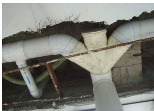
IMAGEN 84.- TUBERÍA DE PVC, INJERTADA A LA TUBERÍA DE FIERRO FUNDIDO.
