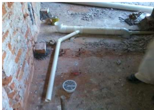
IMAGEN 235.- TUBERÍA DE PVC EN VESTIDOR DOCTORES.
