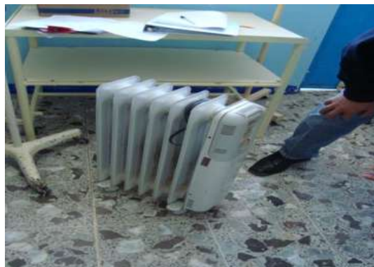
IMAGEN 16.- EN TERAPIA INTENSIVA SE UTILIZABAN EQUIPOS DE CALEFACCIÓN PARA PODER TENER UN ÁREA ACORDE A LOS REQUERIMIENTOS DE LOS PACIENTES INFANTILES ENFERMOS, POR LAS CONDICIONES EN MAL ESTADO DEL AIRE ACONDICIONADO; TAMBIÉN PODEMOS OBSERVAR EL TIPO DE PISO QUE PREDOMINA EN UN 80 % DE LAS ÁREAS, QUE PRÁCTICAMENTE ESTÁ FUERA DE NORMA.
