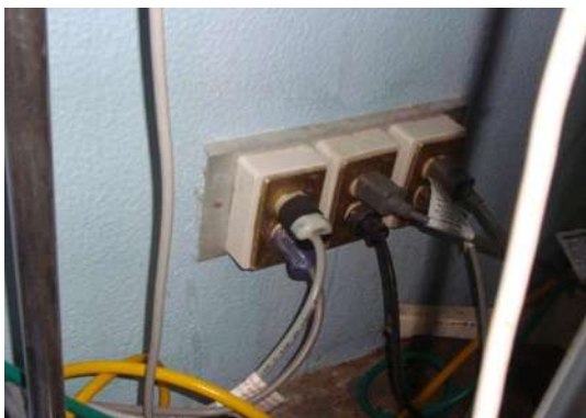
IMAGEN 10.- INSTALACIONES ELÉCTRICAS EN TERAPIA INTENSIVA.
