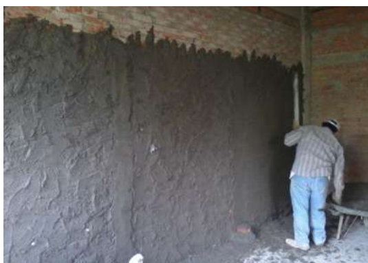
IMAGEN 180.- SE APLANÓ DESPUÉS DE QUITAR TODO EL AZULEJO PARA RECIBIR EL ACABADO.
