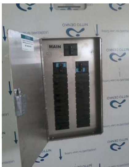
IMAGEN 105.- TABLERO DE AISLAMIENTO PARA TERAPIA INTENSIVA.
