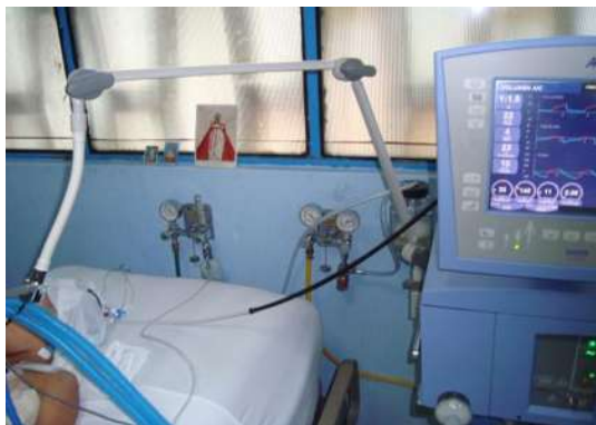
IMAGEN 12.- AQUÍ VEMOS LAS CONDICIONES EN ESTÁN FUNCIONANDO LOS EQUIPOS DE SOPORTE DE VIDA, ASÍ COMO LAS INSTALACIONES DE AIRE Y OXÍGENO, SON INSTALACIONES VITALES PARA LOS PACIENTES INFANTILES.
