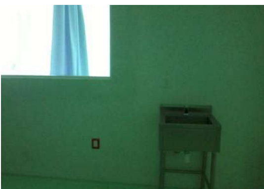
IMAGEN 89.-LAVAMANOS EN AISLADO.
