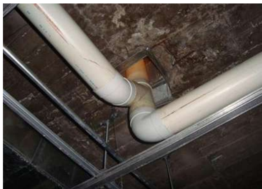
IMAGEN 82.-TUBERIA DE PVC, INJERTADA A LA TUBERÍA DE FIERRO FUNDIDO
