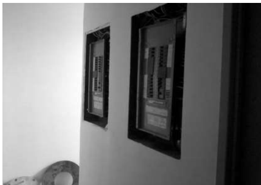
IMAGEN 249.-TABLEROS DE EMERGENCIA Y NORMAL.
