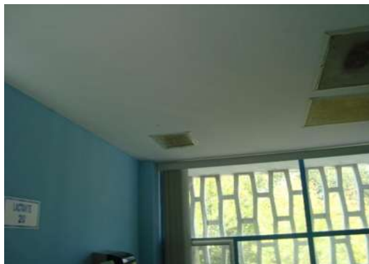
IMAGEN 38.- PLAFÓN EN MALAS CONDICIONES CON REJILLAS SIN CAMBIAR.
