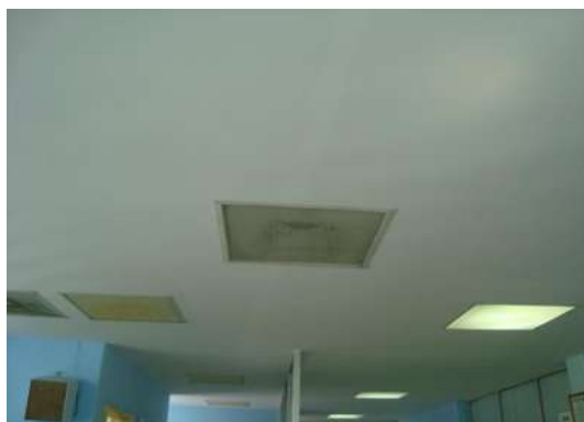
IMAGEN 61.-AIRE ACONDICIONADO EN MAL ESTADO.
