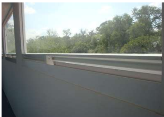
IMAGEN 224.- VENTANA CON SALIDA DE AIRE EN PASILLO.
