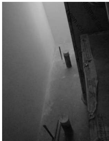
IMAGEN 233.- SALIDAS HIDRÁULICAS PARA AUTOCLAVES
