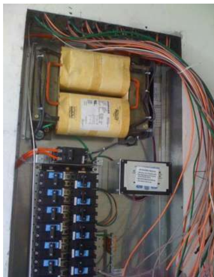
IMAGEN 251.-TABLERO DE AISLAMIENTO.
