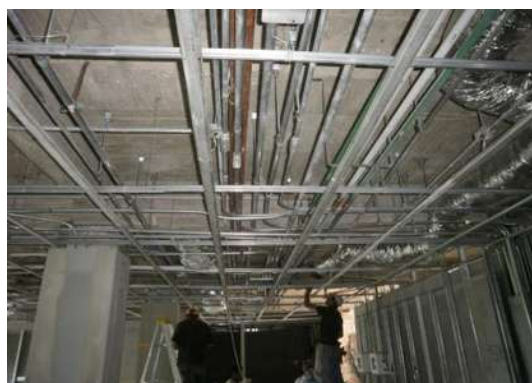
IMAGEN 80.- RED DE TUBERÍA DE AGUA FRÍA Y AGUA CALIENTE CON TUBERÍA DE COBRE.
