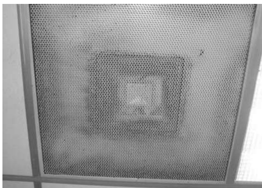
IMAGEN 60.-REJILLA DE INYECCIÓN AIRE ACONDICIONADO.
