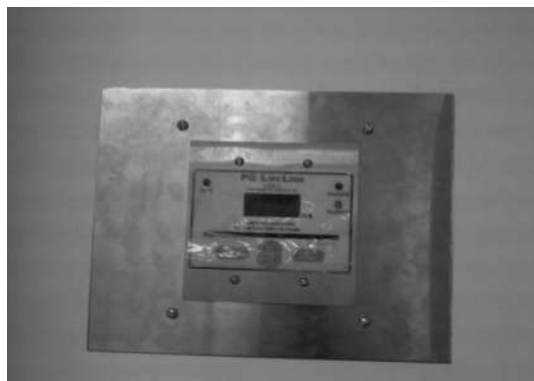
IMAGEN 102.-ALARMA PARA FALLA DE MÓDULO DE CONTACTOS.
