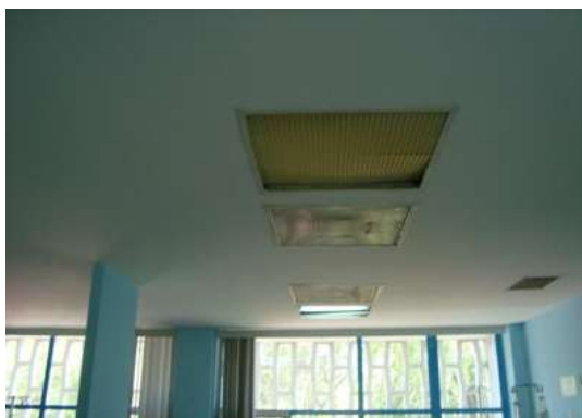
IMAGEN 39.- LUMINARIAS Y AIRE ACONDICIONADO.
