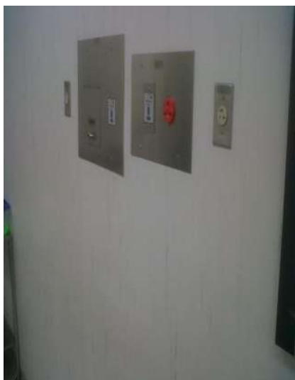
IMAGEN 253.-TABLERO PARA RAYOS "X" NORMAL Y DE EMERGENCIA.
