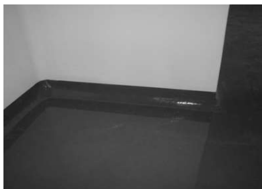
IMAGEN 211.- CURVA SANITARIA EN PISO DE QUIRÓFANO 2
