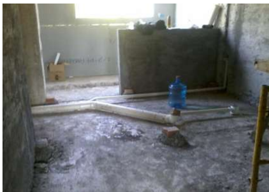
IMAGEN 234.- TUBERÍA DE PVC EN VESTIDOR DOCTORES.
