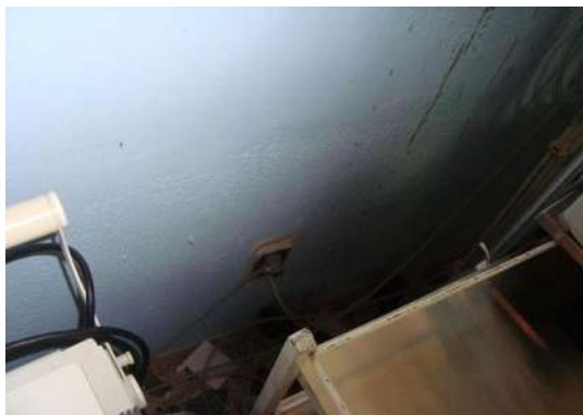
IMAGEN 14.- AQUÍ PODEMOS OBSERVAR EQUIPOS CONECTADOS A INSTALACIONES ELÉCTRICAS EN CONTACTOS QUE NO SON DE GRADO HOSPITALARIO ÁREA DE TERAPIA INTENSIVA.
