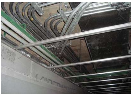
IMAGEN 79.- RED DE TUBERÍA DE AGUA FRÍA Y AGUA CALIENTE CON TUBO PLUS.
