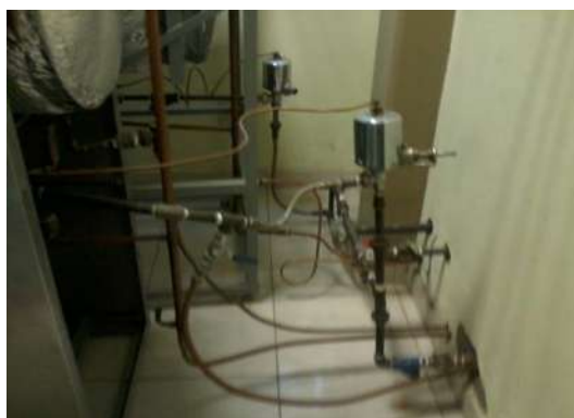
IMAGEN 45.- AUTOCLAVES DE QUIRÓFANOS.
