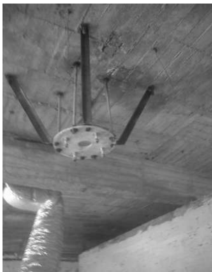
IMAGEN 166.- RETIRO DE BASE PARA LÁMPARA DE CIRUGÍA EN SALA DE OPERACIONES.
