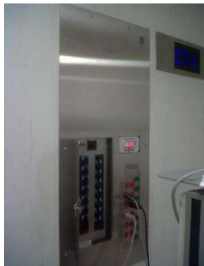
IMAGEN 252.- TABLERO DE AISLAMIENTO EN QUIRÓFANOS.
