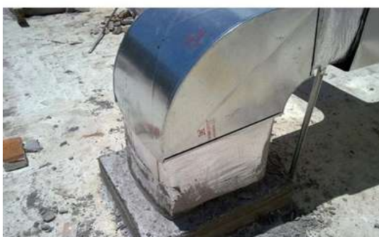
IMAGEN 111.-DUCTOS DE AIRE ACONDICIONADO.
