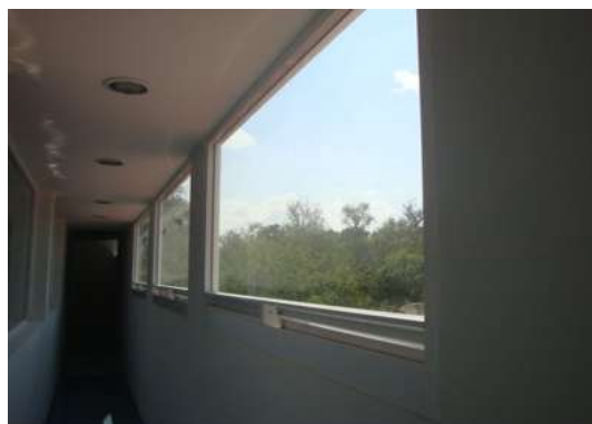
IMAGEN 225.- VENTANA CON SALIDA DE AIRE EN PASILLO.
