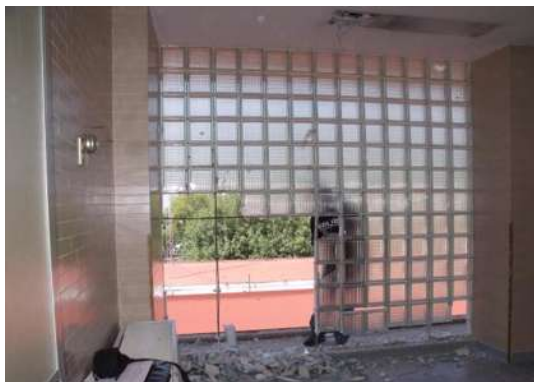
IMAGEN 50.- AZULEJO Y BITROBLOK EN QUIRÓFANOS.
