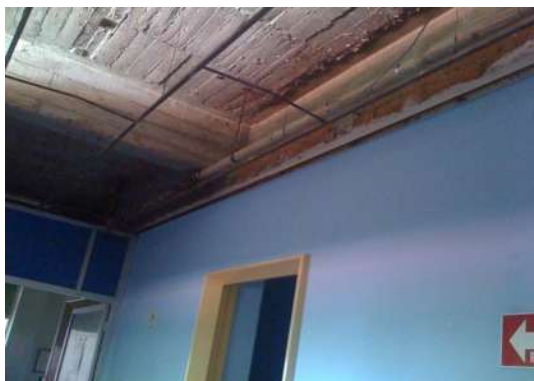
IMAGEN 52.-INSTALACIONES ELÉCTRICAS EN MAL ESTADO POR PLAFÓN
