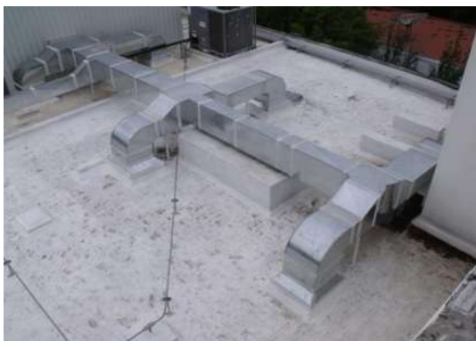
IMAGEN 109.-AZOTEA SISTEMA DE AIRE ACONDICIONADO.
