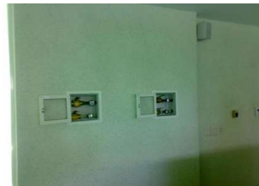
IMAGEN 94.- VÁLVULAS DE SECCIONAMIENTO AIRE Y OXÍGENO.
