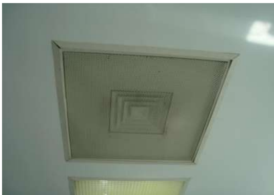
IMAGEN 37.- REJILLAS EN MAL ESTADO DE AIRE ACONDICIONADO.
