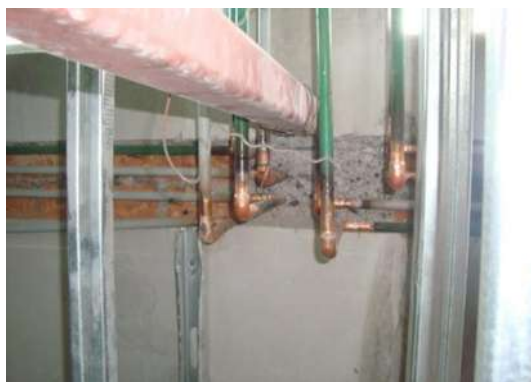
IMAGEN 92.-TUBERÍAS DE AIRE (GRIS) Y OXÍGENO (VERDE) COLORES PARA IDENTIFICARLOS.
