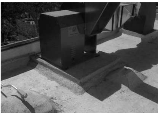
IMAGEN 115.-EXTRACTORES DE AIRE
