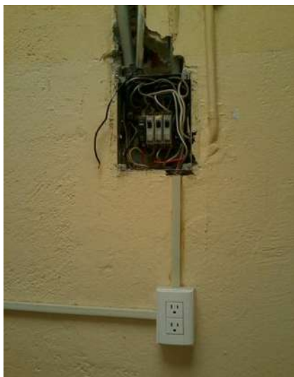
IMAGEN 168.- CENTRO DE CARGA PARA CEYE.
