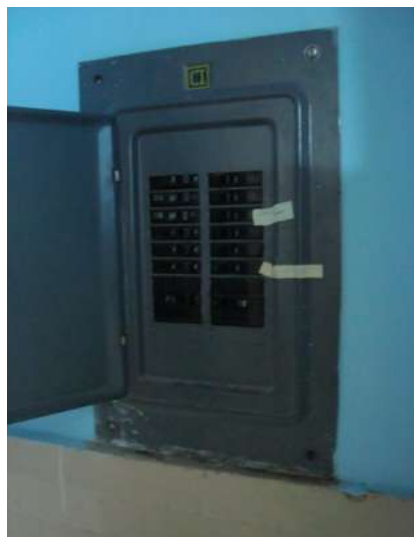
IMAGEN 169.- TABLERO PARA ILUMINACIÓN Y CONTACTOS DE QUIRÓFANOS.
