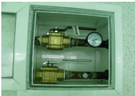
IMAGEN 93.- VÁLVULAS DE SECCIONAMIENTO.
