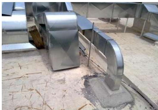
IMAGEN 112.- DUCTOS DE AIRE ACONDICIONADO.
