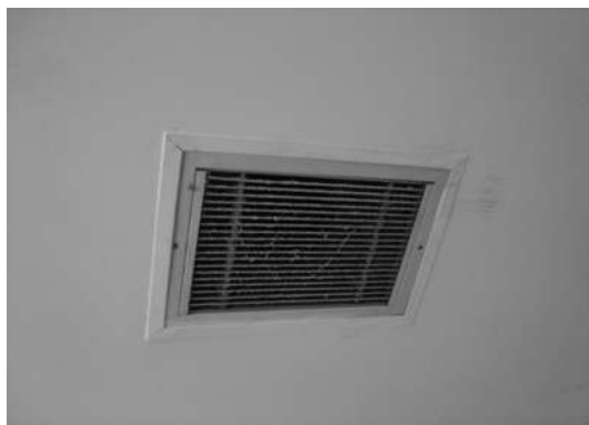
IMAGEN 63.-AIRE ACONDICIONADO REJILLA DE EXTRACCIÓN.
