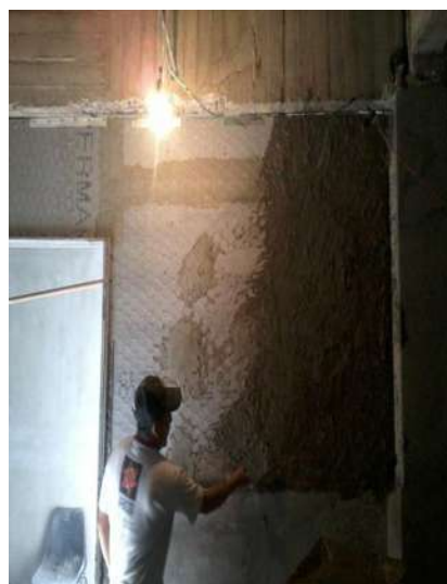
IMAGEN 187.- APLANO CON SULFATO DE BARIO EN 1 QUIRÓFANO...
