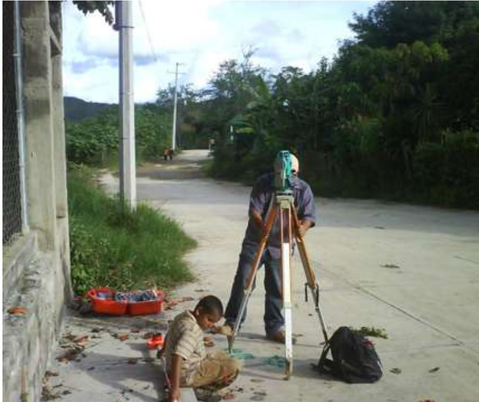
Procedimiento típico de establecimiento de una estación de trabajo para efectos del levantamiento topográfico
