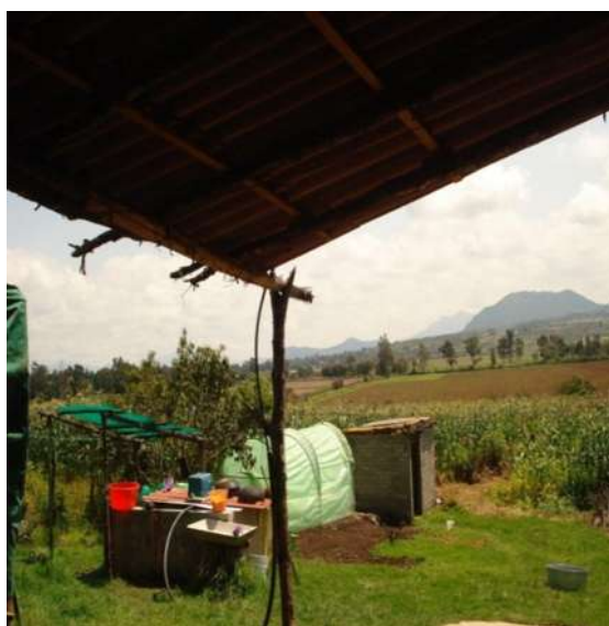
Imagen 5.20.- Poliducto de conducción del biogás.
