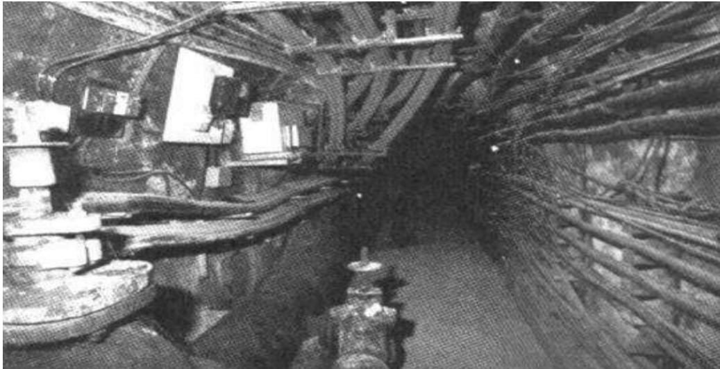
Imagen III.5.7.1. Galería de servicios
