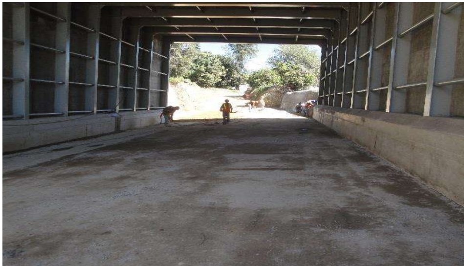
Imagen VII.4.23.6. Base hidráulica en interior del túnel
