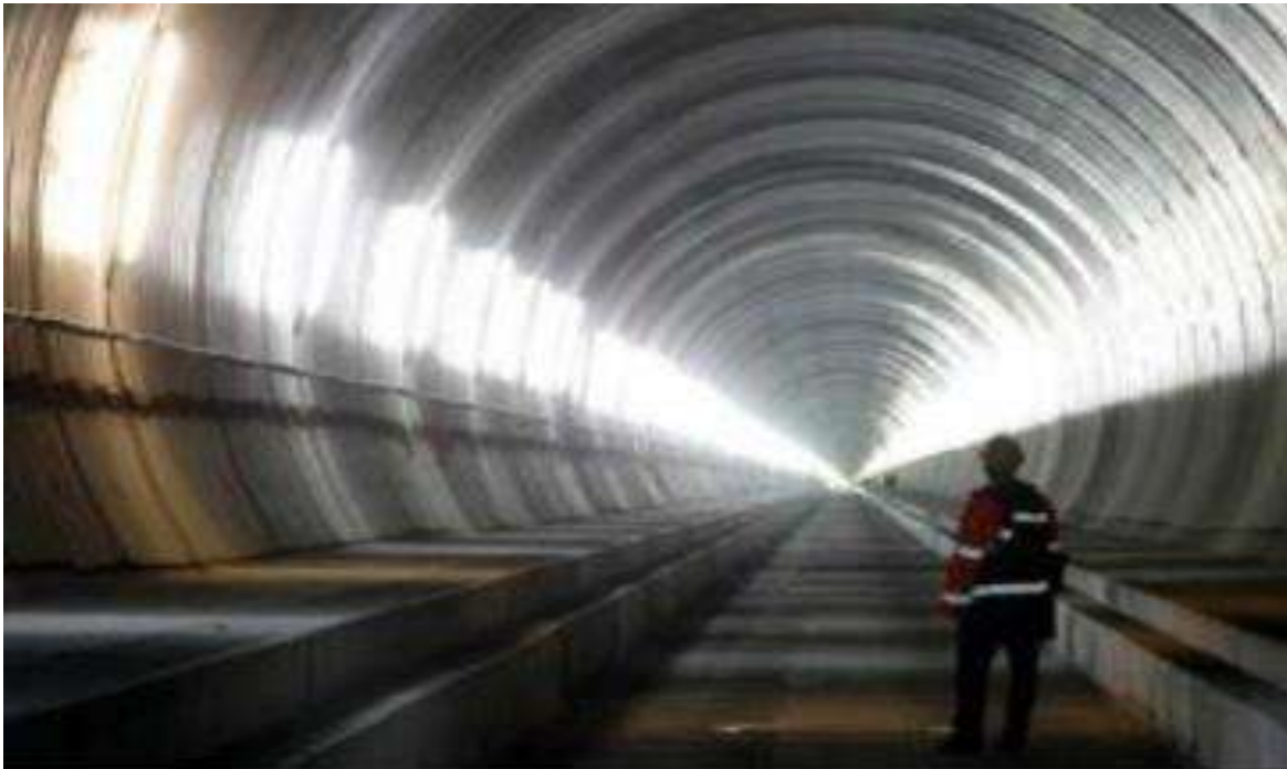
Imagen VI.12.1. Instalaciones especiales en túneles
