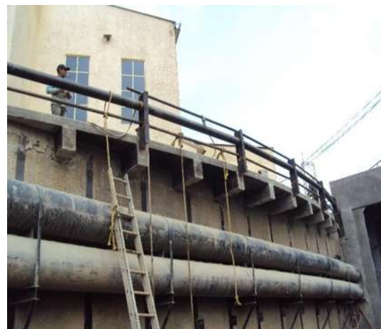
Imagen VII.4.22.11. Barandal de protección
