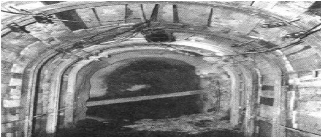
Imagen V.19.2.1. Cerchas con tablones en el sostenimiento provisional de una galería de avance
