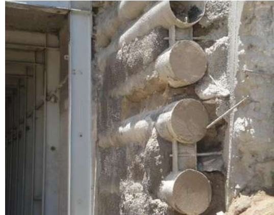
Imagen VII.4.15.4. Tubos laterales llenos
