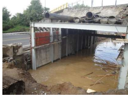
Imagen VII.4.13.14. Inundación del túnel
