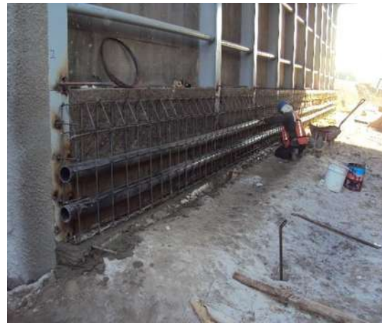
Imagen VII.4.18.4. Tubería para instalaciones
