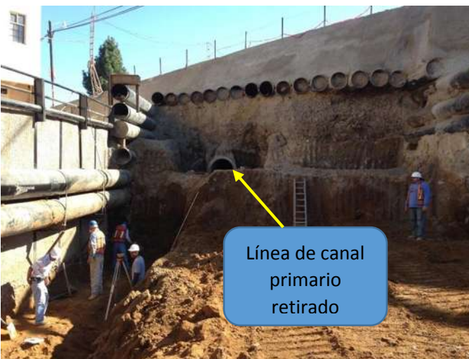
Imagen VII.4.8.5. Portal sin tubería de agua
