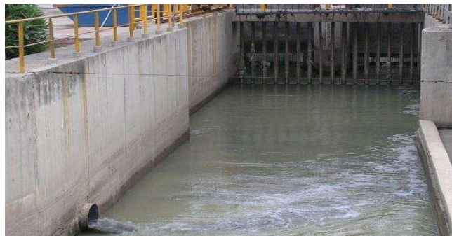
Imagen 3.2 - Reja Vertical de Limpieza Manual en operación
