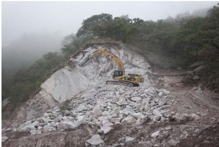
Corte de material, con Excavadora equipada con martillo, de acuerdo a las secciones del proyecto
