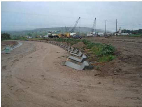
Ilustración 76 Cuneta Obra De Drenaje.
