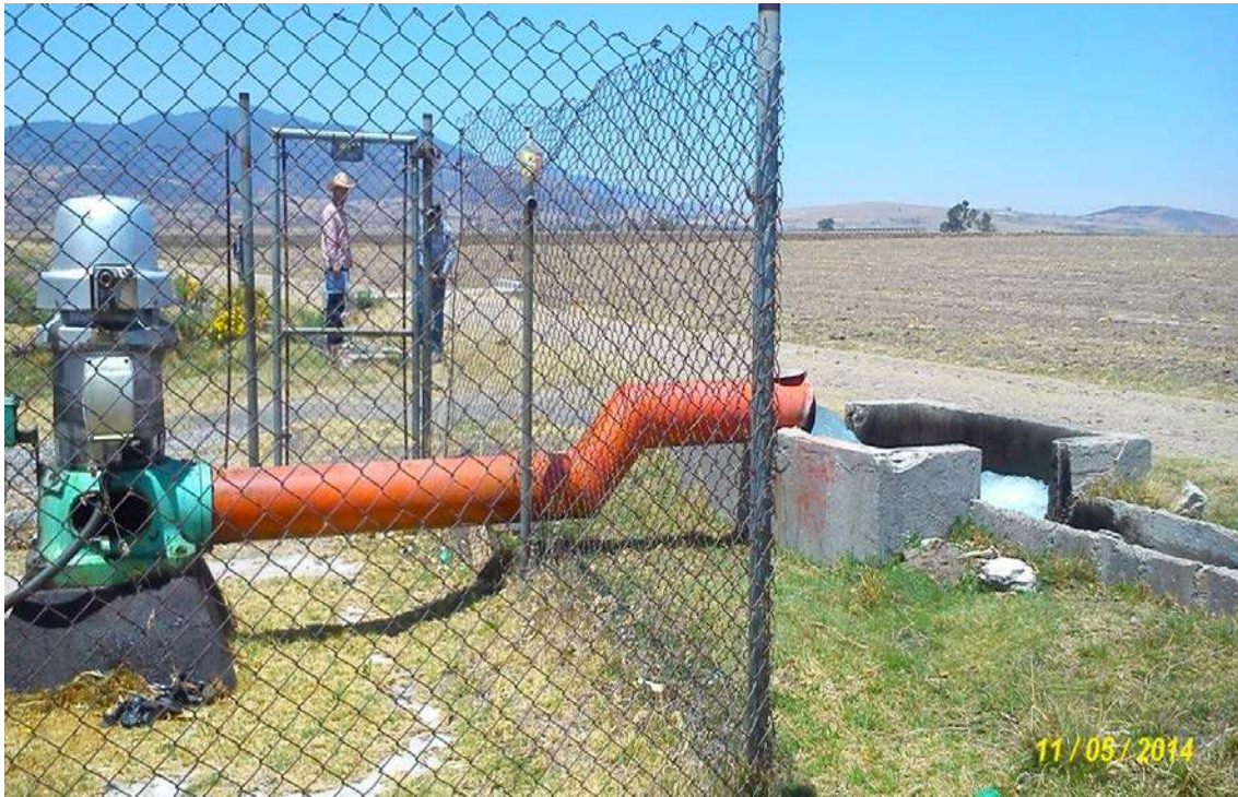
Imagen que muestra equipo de bombeo
