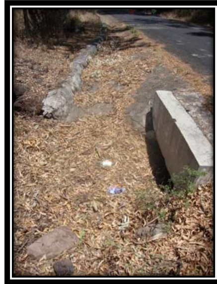
Obra de drenaje tipo alcantarilla ubicada en el km 1+300 franja izquierda, en estado de azolve.
