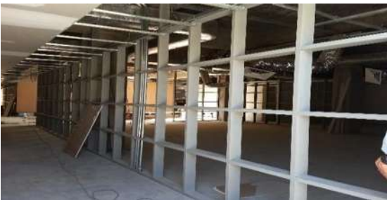
Img 21. Protección de la estructura del muro con una capa de pintura.
