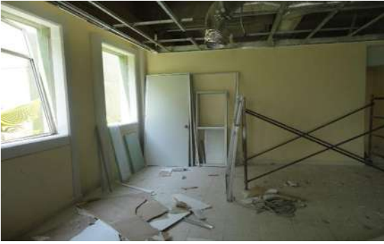
Img 5. Retiro de cancelería de aluminio puertas del edificio
