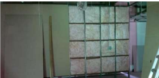
Img 23. Colocación total de los bloques de lama y tubería de instalación eléctrica.
