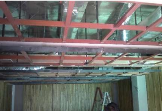
Img 32. Estructura de PTR sujeta a la losa para plafón de madera dentro de las salas.
