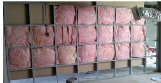
Img 22. Colocación de los bloques de lama mineral y parte exterior del muro.
