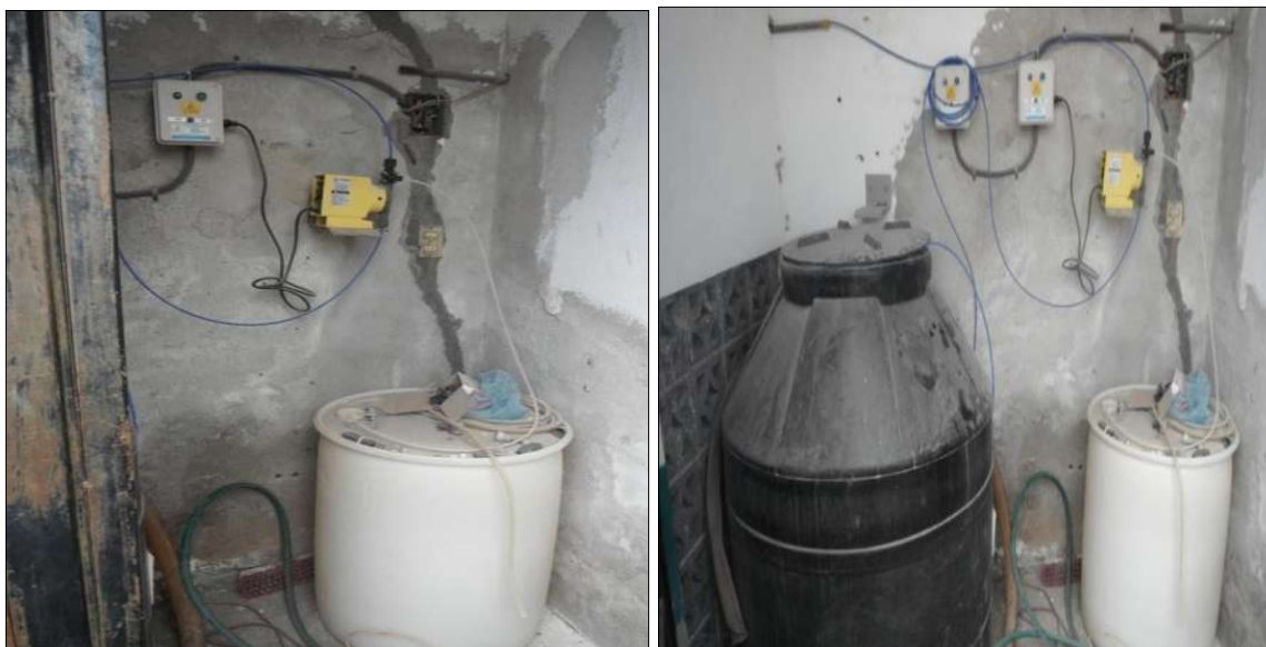
Figura 14. Estado actual del dispositivo de cloración.
