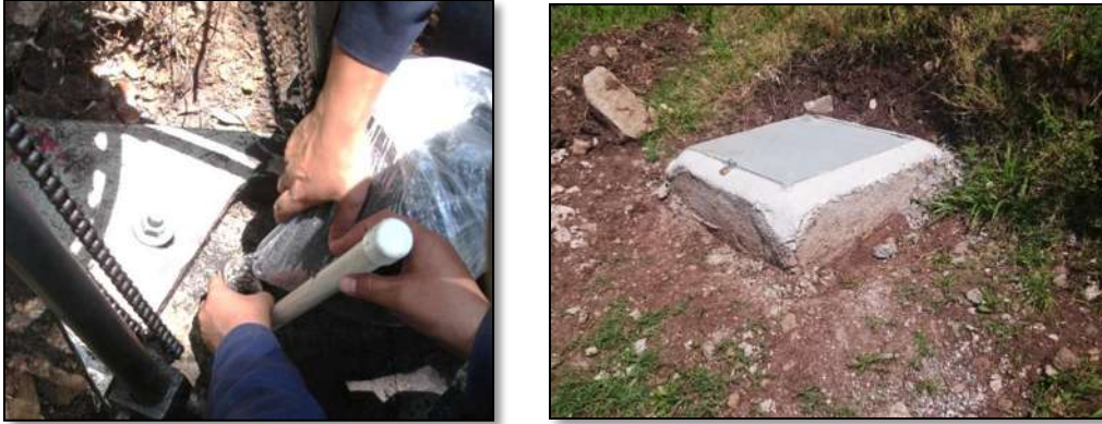
FIGURA 31. Tubería piezométrica y registro de protección.
