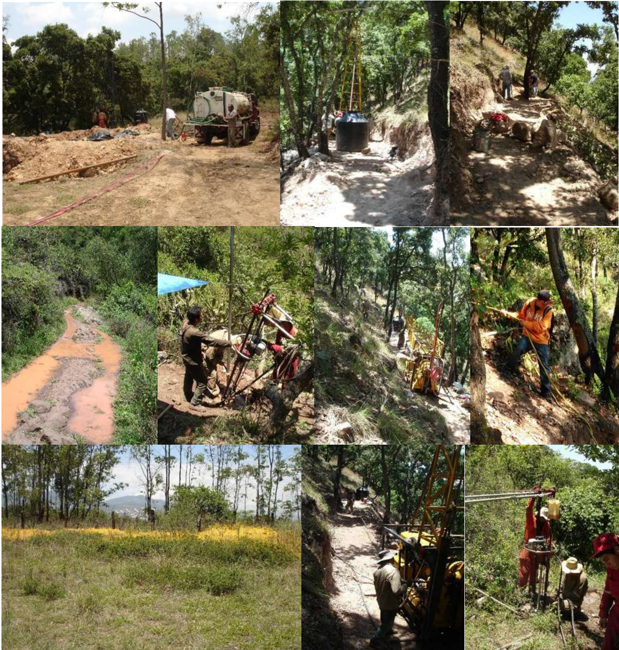
Figura 4.26 Trabajos de acceso y acondicionamiento para la realización de los sondeos exploratorios.
