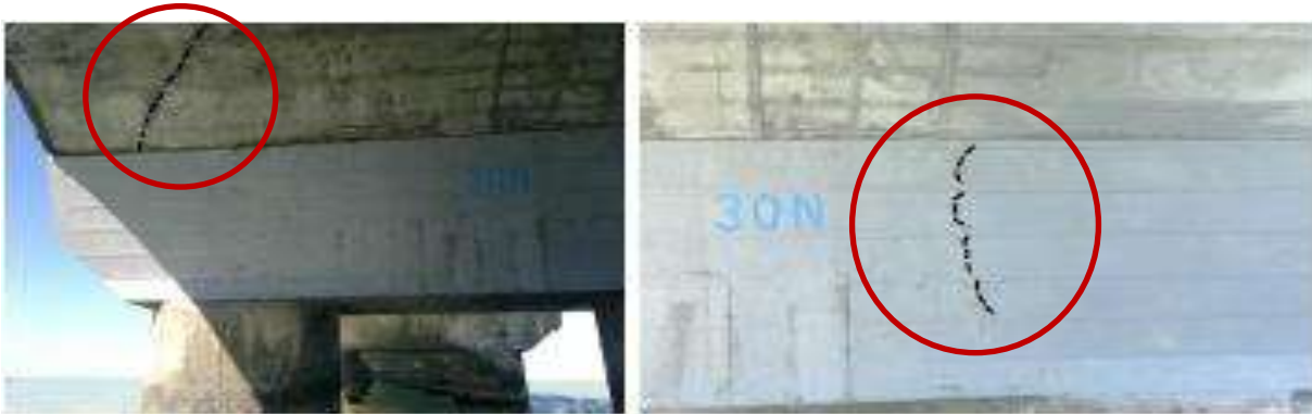
Figura 10. Aparición de nuevas fisuras en apoyo 30 de viaducto, que 3 años antes ya había sido reforzado. Causado por continuo tránsito de grandes cargas sobre el Viaducto.
