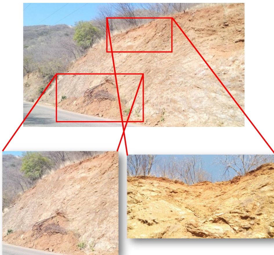
Figura 3-16 fotografía que detalla la falla de suelo en forma de cuña
