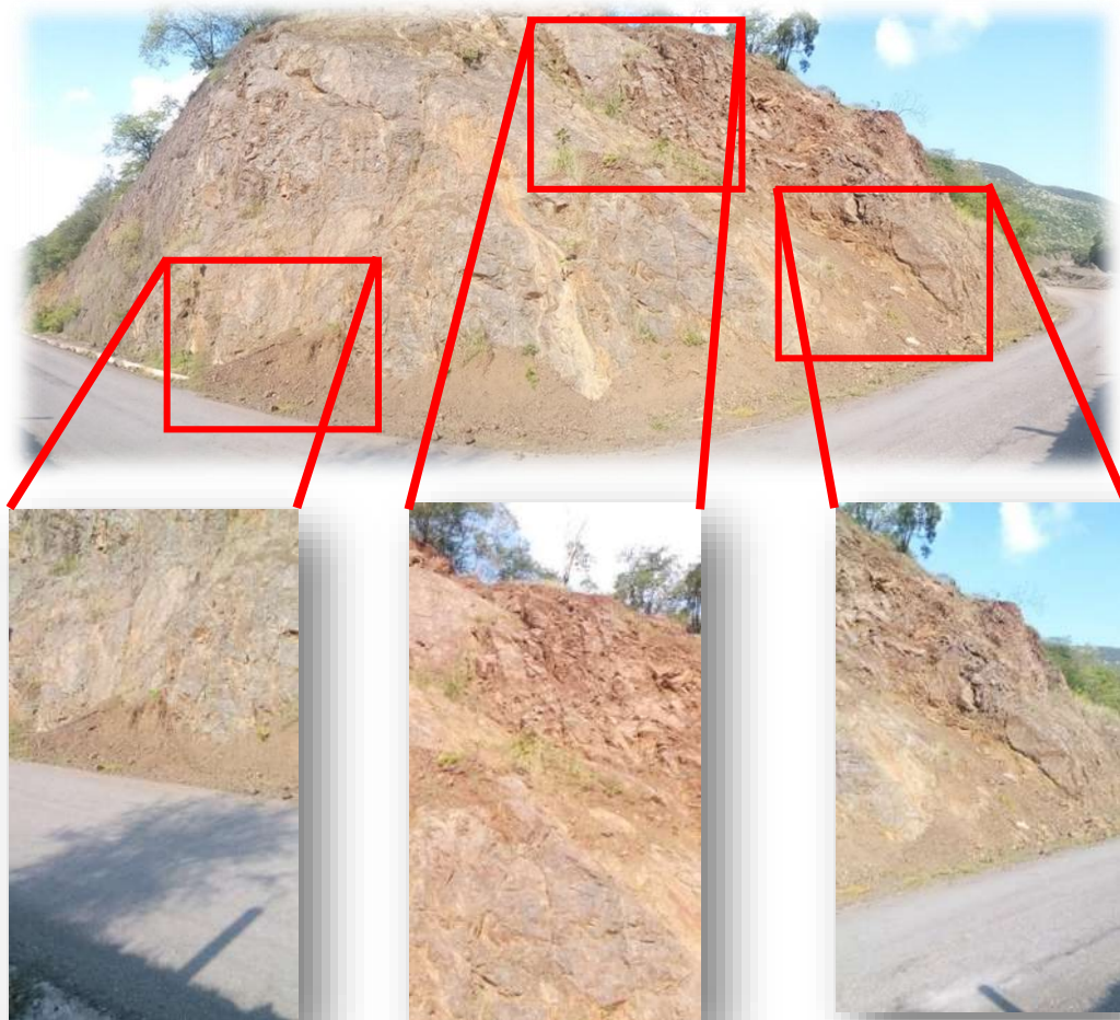
Figura 3-146 detalles de los problemas que presenta el talud en la actualidad (2016)
