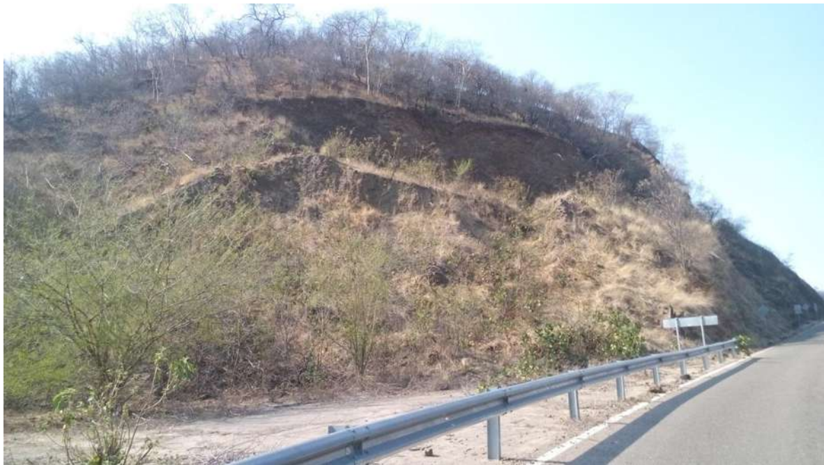
Figura 3-7 fotografías del talud uno del 2017 donde se puede ver la forma y estado en que se encuentra.
