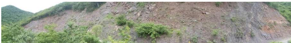
Figura 3-112 imagen panorámica del talud 20 en el 2016.
