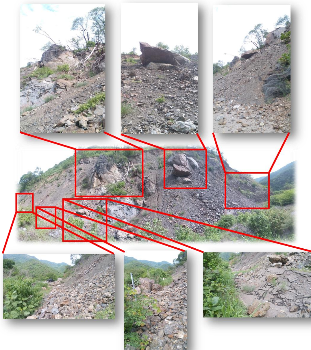
Figura 3-126 detalles de los problemas que presenta el talud 21 en el 2016.
