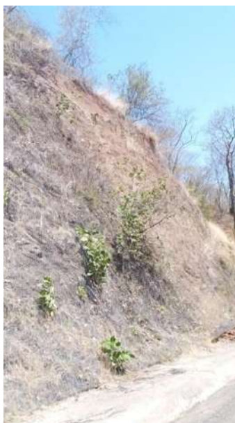
Figura 3-63 imagen del estado que presenta el talud 10 en el 2016
