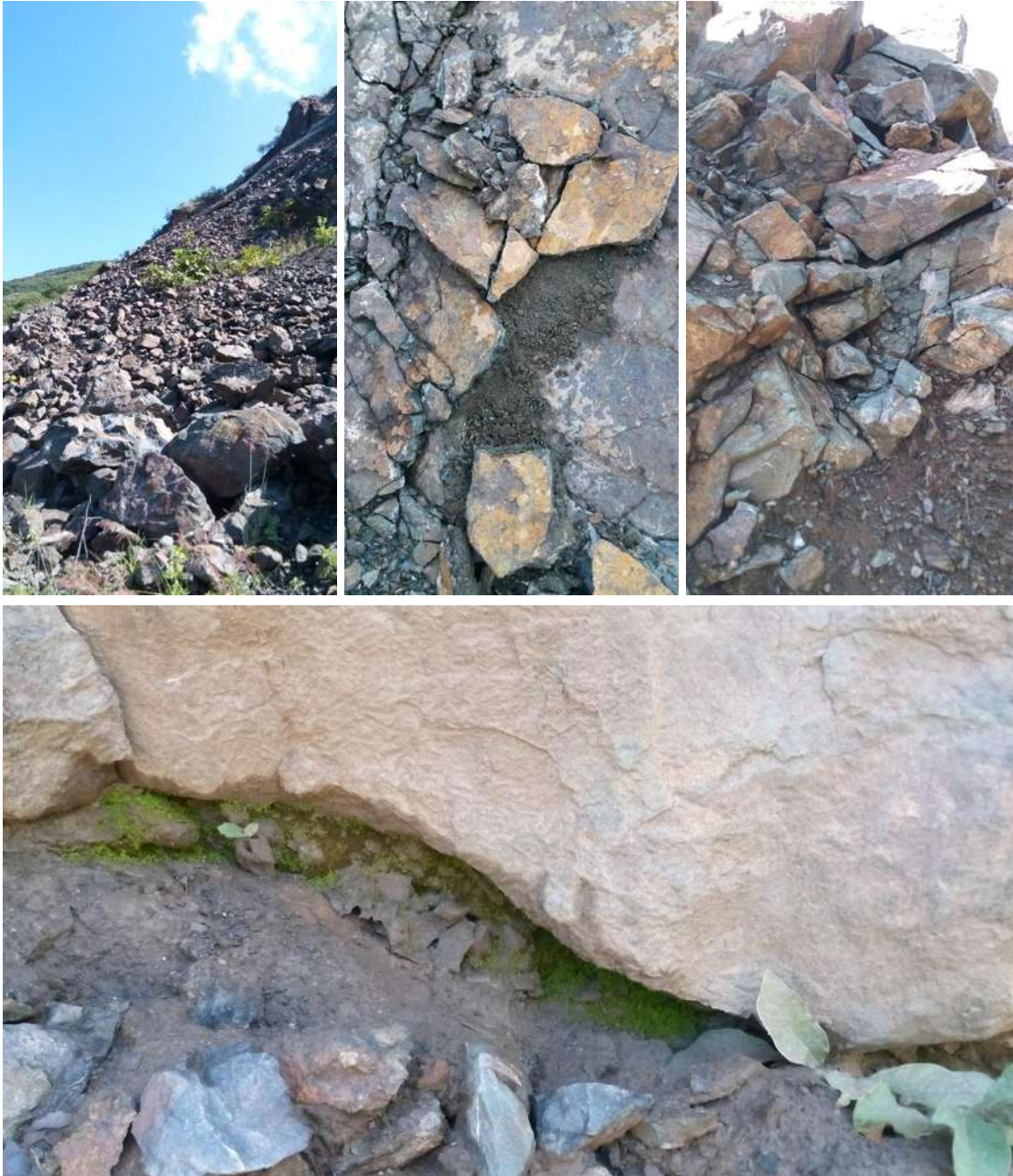
Figura 3-154 detalles de los problemas que presenta este corte.
