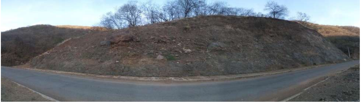
Figura 3-41 fotografía del talud 6 donde se ve su estado tomada en el 2016.
