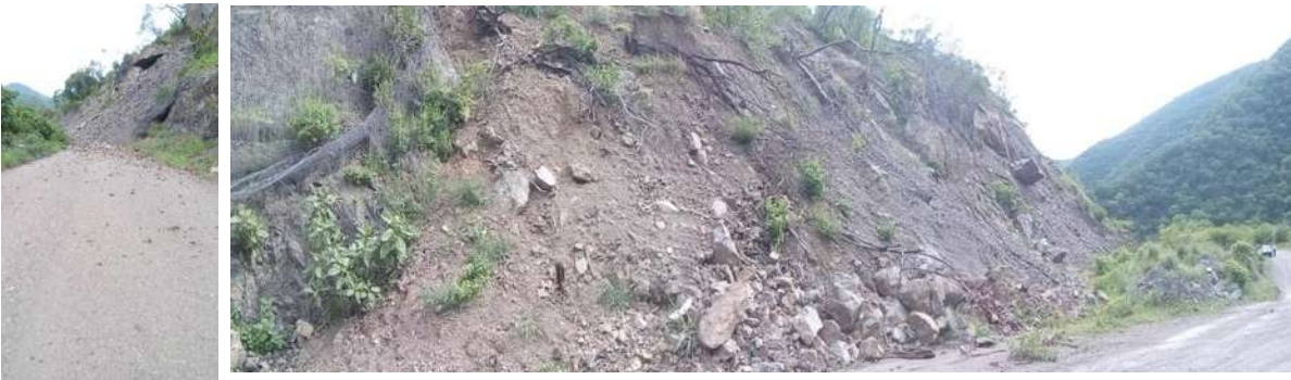
Figura 3-125 imágenes representativas del estado en el que se encuentra el talud 21.
