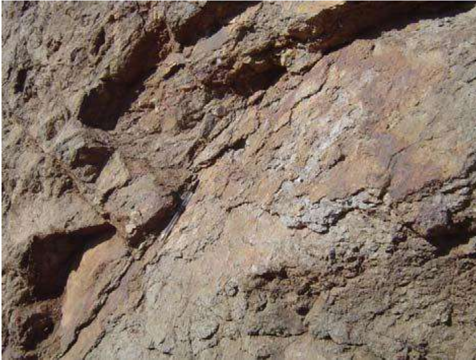
Figura 3-12 Detalle de discontinuidad, talud 2. (Chávez y Arreygue 2009).
