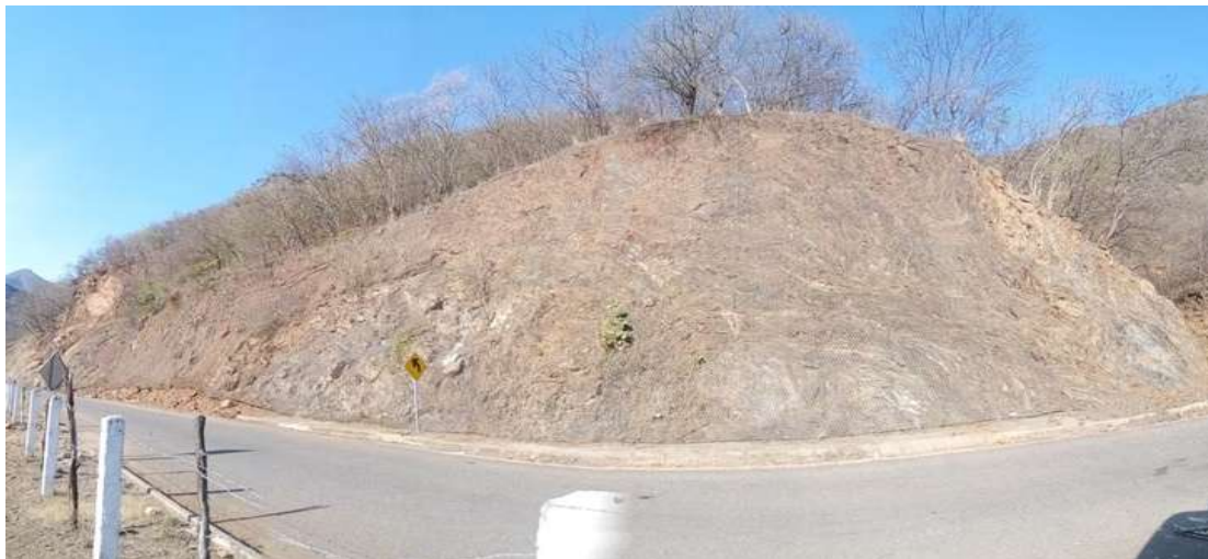
Figura 3-46 imagen panorámica del estado que presenta el talud 7 en el 2016
