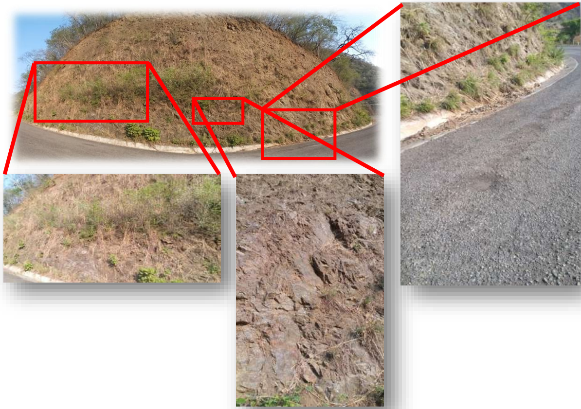
Figura 3-93 fotografías donde se muestra el estado del talud 15 en el 2016.
