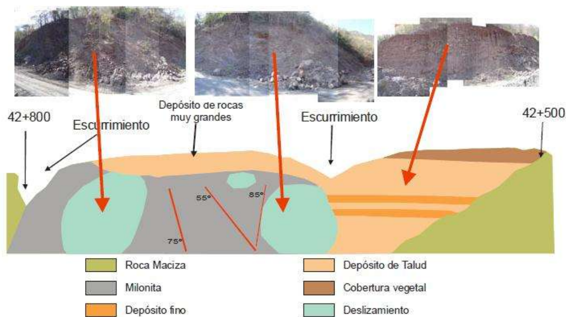
Figura 3-42 Perfil del talud siete, se indican los cambios litológicos y las estructuras que están involucradas. (Chávez y Arreygue 2009).
