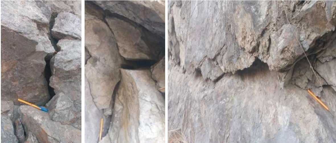
Figura 3-32 Imágenes donde se puede ver el estado de la roca en el talud, las grietas.
