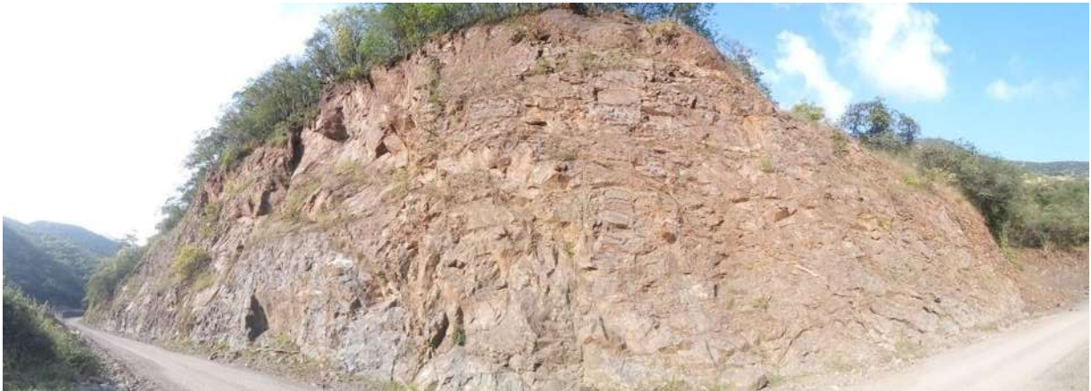
Figura 3-143 imagen panorámica del estado actual del talud en el 2016
