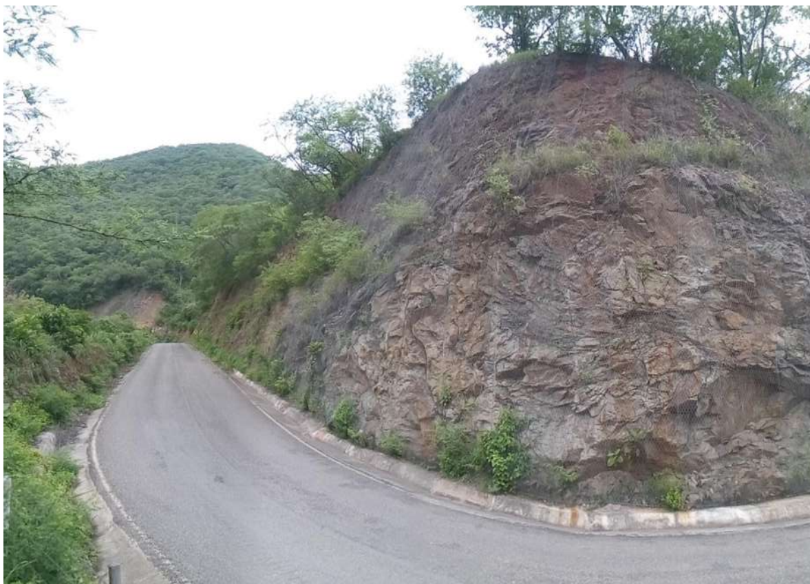
Figura 3-108 foto del estado que presenta el talud 19 en el 2016.
