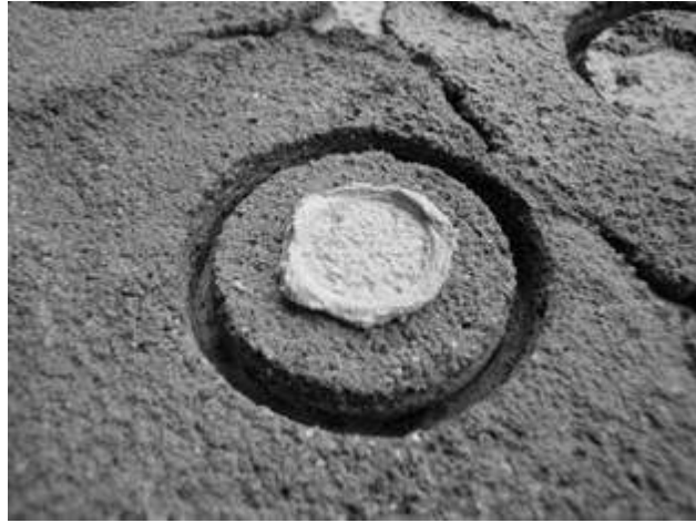
Ilustración 68. Falla entre epóxico y el disco metálico. Fuente: (Bernabé Reyes, 2015)
