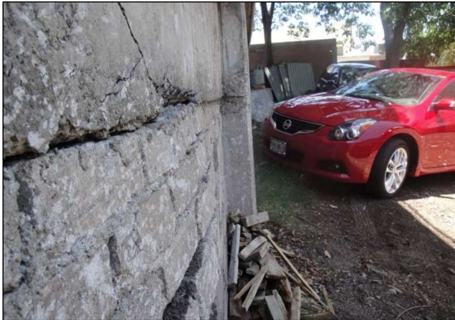
Figura 3.2.16. Fracturas y grietas tanto en las trabes y los muros de contención que son parte de la cimentación del edificio donde se encuentra la biblioteca. En esta toma se puede apreciar que cerca de este edificio se encuentra el estacionamiento.
