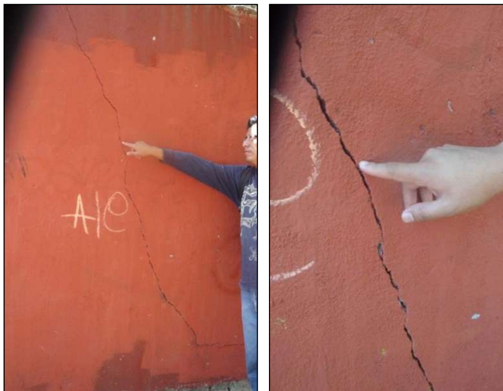
Figuras 3.2.32. Grietas en el muro trasero de la barda perimetral de la escuela.
