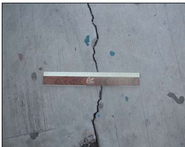
Figura 3.2.10. Grietas en los pasillos de la Escuela
