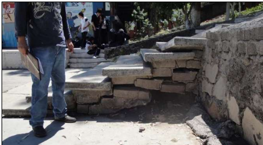
Figura 3.2.27. Fractura de la escalera de acceso al tercer nivel del terreno.
