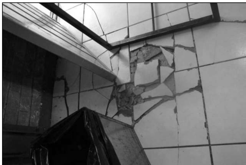
Figura 3.2.19. Fractura del piso de la biblioteca en el edificio 1 de la escuela secundaria.
