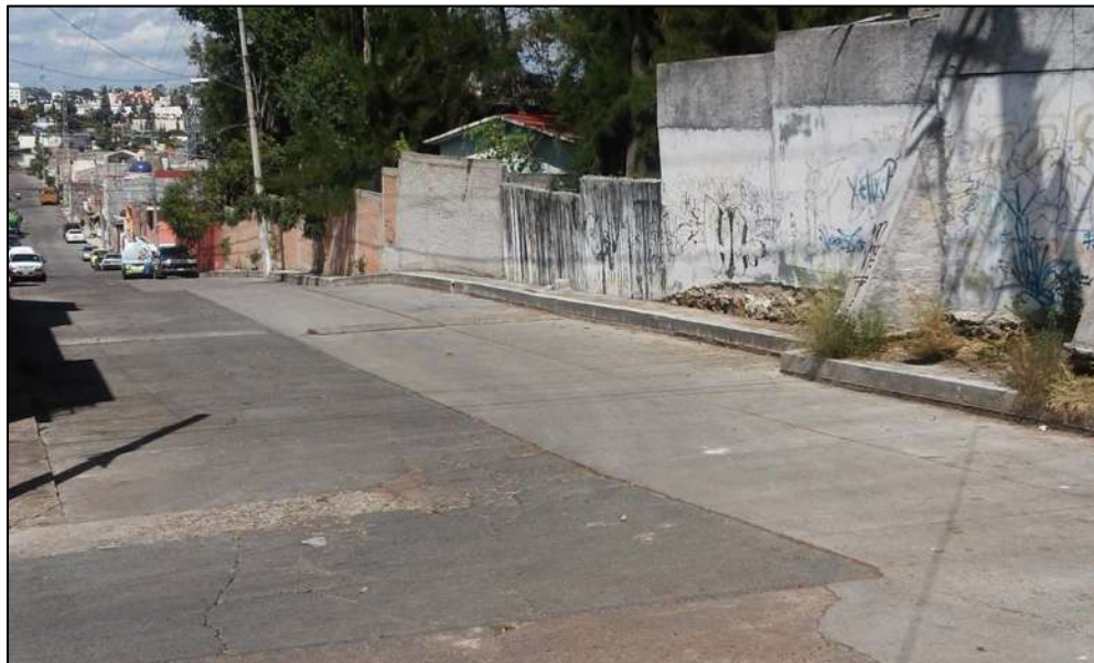
Figura 3.2.4. Cimentación descubierta y grietas presentes en las barda perimetral poniente de la Escuela Secundaria no. 77.
