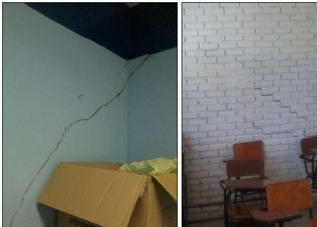
Figuras 3.2.17, Grietas en las paredes de algunos de los salones de la escuela. Estas grietas a simple vista se ven que tienen forma diagonal, característicos de un esfuerzo cortante. a.) (fotografía izquierda) grieta de un cubículo al lado del salón de taller de vestido. b.) (fotografía derecha) Grieta en el salón del taller del vestido.
