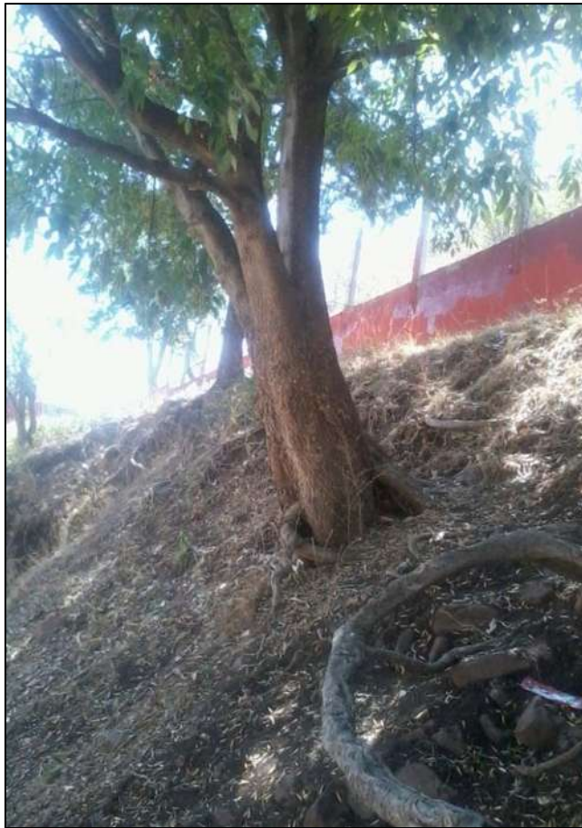
Figura 3.2.36. Inclínación de uno de los árboles que se encuentran adentro de la escuela, esta inclinación es provocada por el deslizamiento de tierra, lo que quiere decir que el movimiento sigue activo.
