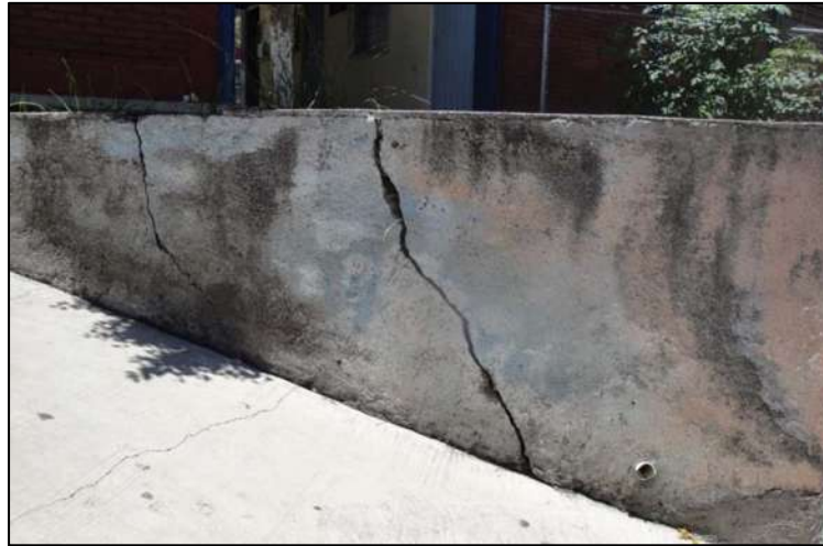
Figura 3.2.26. Otro ángulo de las fracturas del muro cerca de las escaleras de acceso al primer nivel de terreno.
