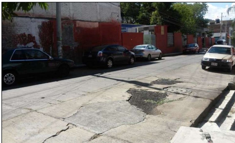
Figura 3.2.6. Grietas presentes en el pavimento de la calle, enfrente de la Escuela Secundaria no. 77
