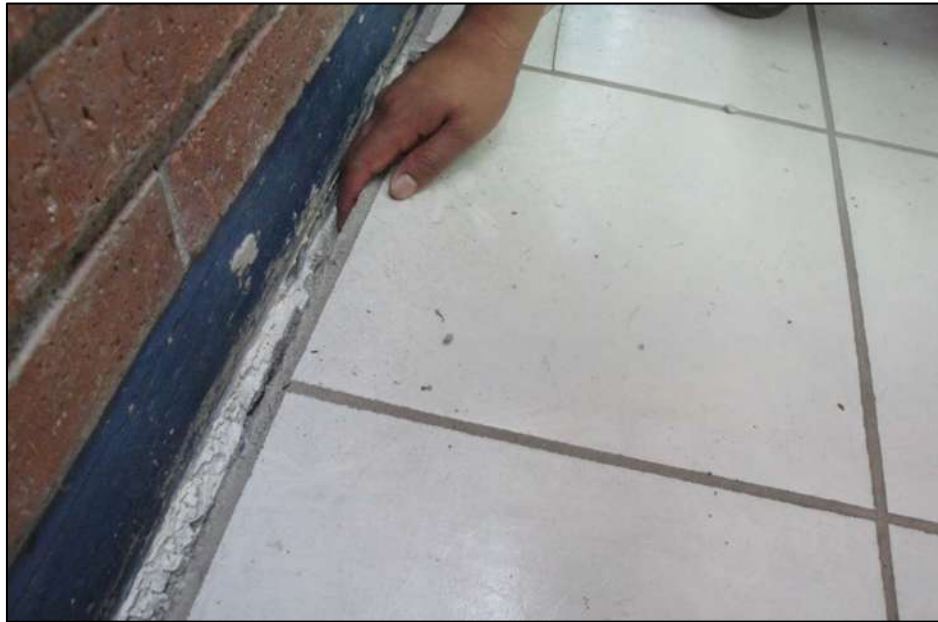
Figura 3.2.20. Abertura en la conexión piso-pared en la biblioteca de la escuela.
