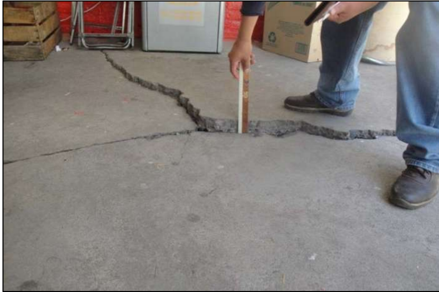
Figura 3.2.22. Fracturas y grietas del piso de la cooperativa, al mismo tiempo hundimiento de la misma.
