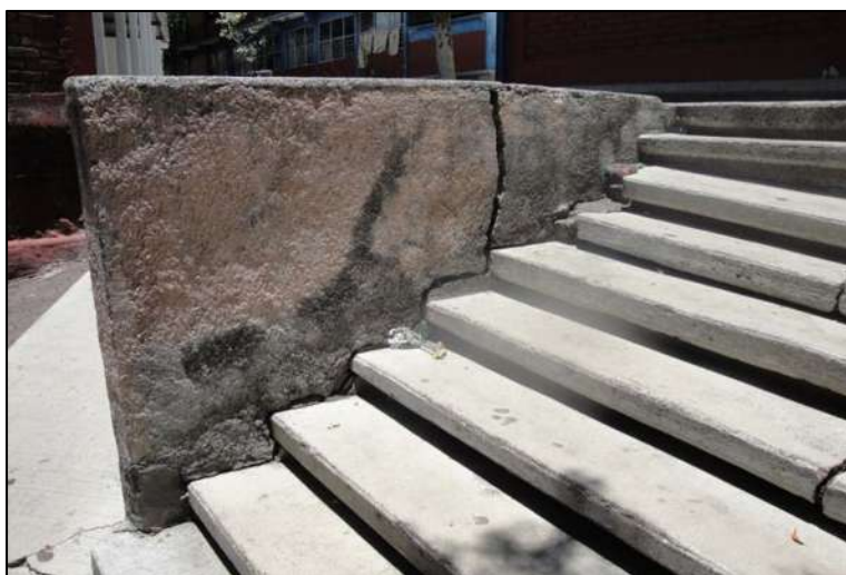
Figura 3.2.25 Fracturas y grietas del muro cerca de las escaleras de acceso al primer nivel de terreno.
