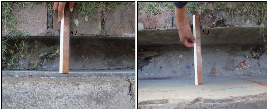
Figuras 3.2.24. Canaleta de mampostería para el desalojo de las aguas pluviales. A simple vista se ve la diferencia de anchos de las dos partes de las canaletas. (F. Izquierda) Parte de la canaleta con el ancho original cuando se construyó, (F. Derecha) Parte de la canaleta con el ancho ya modificado a consecuencia del empuje lateral del material deslizado.
