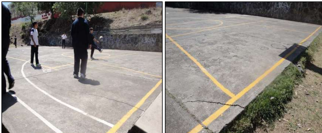
Figura 3.2.28. Pequeñas grietas en las canchas de básquet y voleibol.
