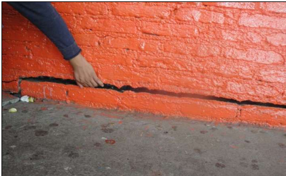
Figura 3.2.23. Grieta en uno de los muros de la cooperativa con abertura de aproximadamente 3 cm.
