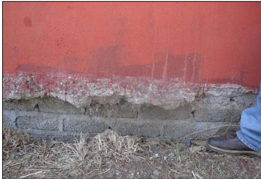
Figura3.2.34. Hundimiento o deslizamiento de terreno al pie del muro de la barda perimetral.
