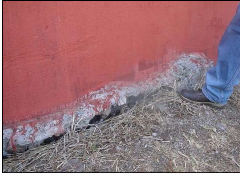
Figura3.2.33. Fracturas en el pie del muro de la barda perimetral de la escuela.
