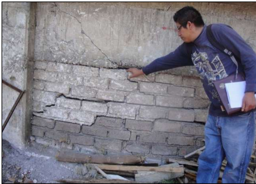
Figura 3.2.15. Fracturas y grietas tanto en las trabes, y los muros de contención de la cimentación del edificio donde se encuentra la biblioteca.
