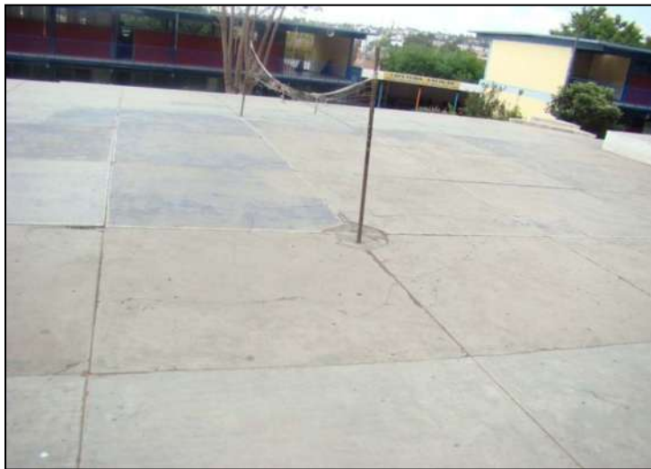
Figura 3.2.11. Grietas en el patio cívico de la escuela secundaria.
