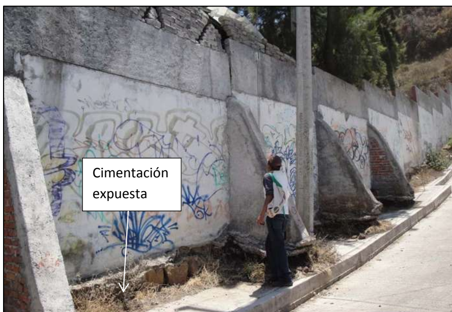
Figura 3.2.7. Erosión debajo de los elementos de retención de la barda.
