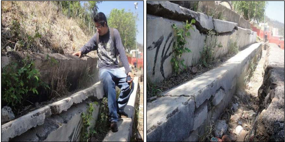
Figuras 3.2.30. Daños por fracturamiento en la estructura tipo grada a consecuencia del empuje de terreno por el deslizamiento de la ladera.
