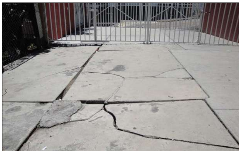
Figura 3.2.12. Fracturas y grietas en el patio pequeño que se encuentra en la parte noreste de la escuela muy próximo a la puerta 3.
