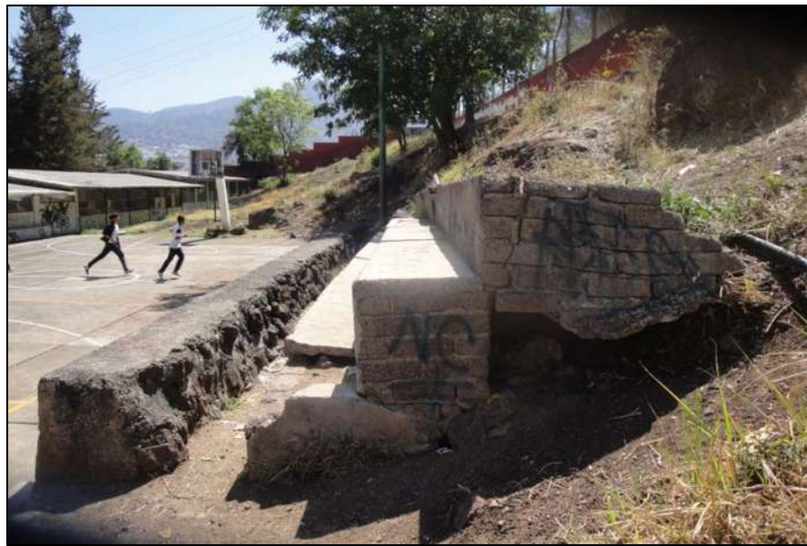
Figura 3.2.31. Otro ángulo de la fractura de la estructura tipo grada.
