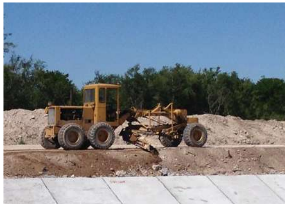
Imagen IV.66: Revestimiento de camino.
