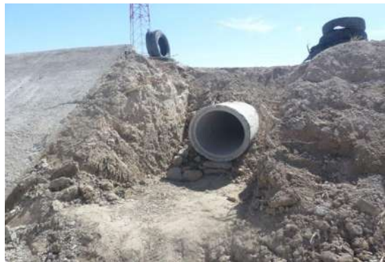
Imagen IV.34: Tubo de concreto de 18" de diámetro para toma directa.
