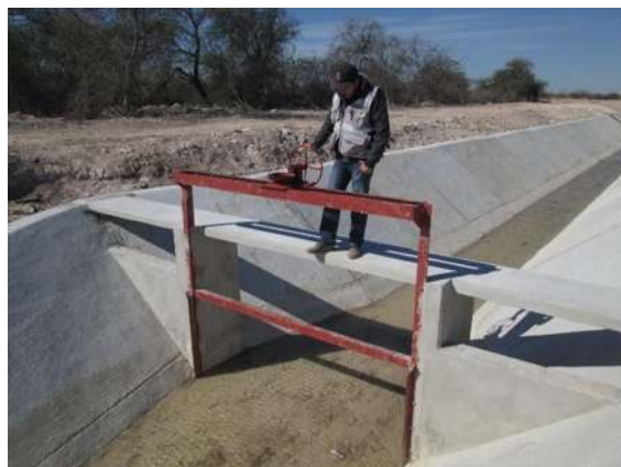
Imagen IV.65: Marco de compuerta en represa.
