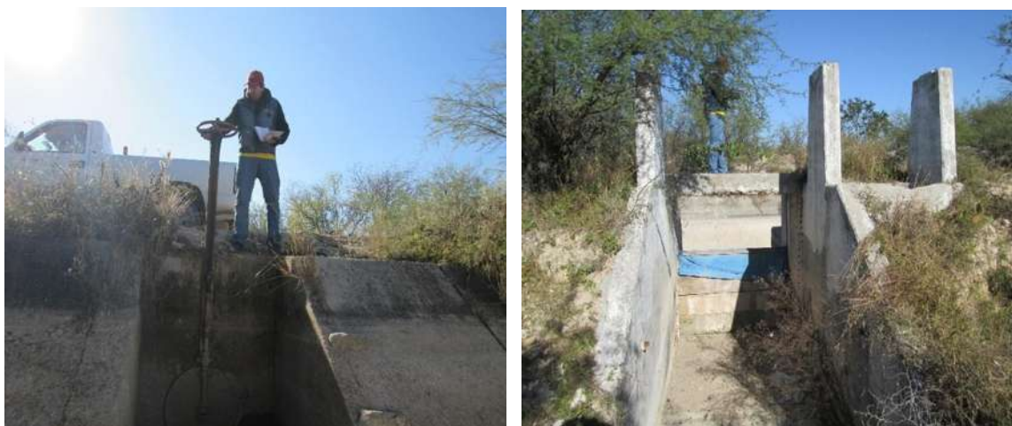
Imagen III.24 y III.25: Compuerta Miller en mal estado y desfogue en Km. 2+074.69.
