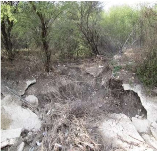
Imagen III.22: losas dañadas en talud.
