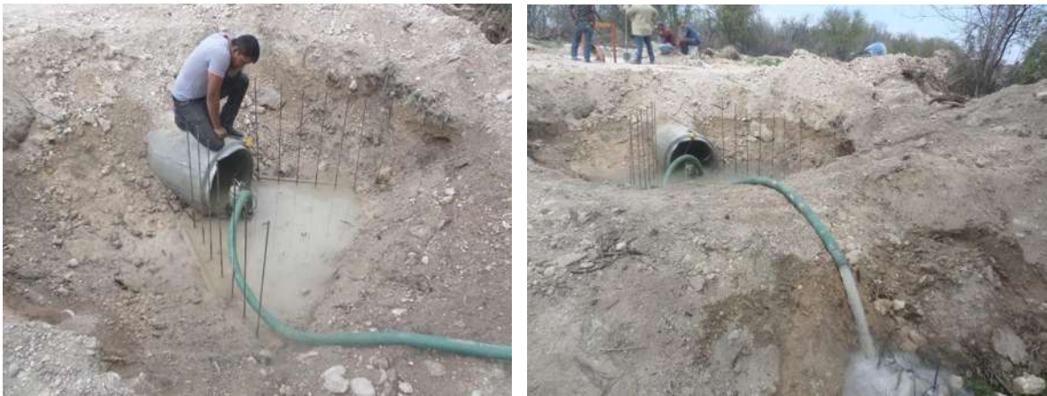
Imágenes IV.36 y IV.37: Uso de bomba de 3" y desagüe de toma directa.
