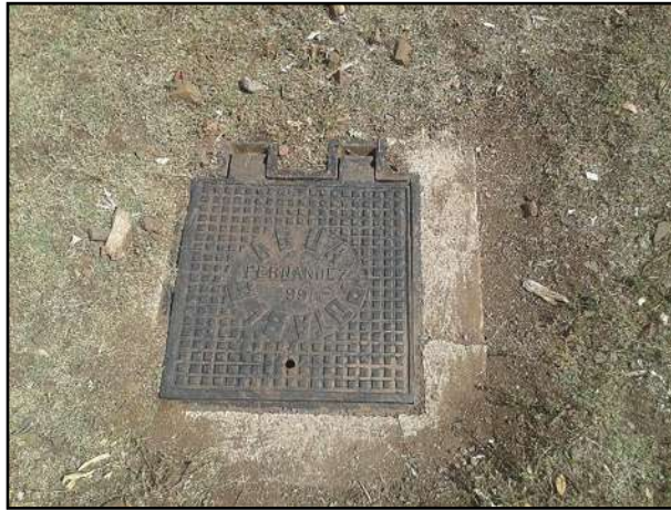
Figura: 4. 2. Registro para red de agua potable.
