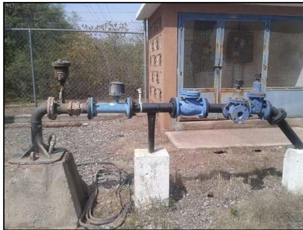
Figura: 5. 2. Tren de descarga de pozo profundo para extracción de agua.
