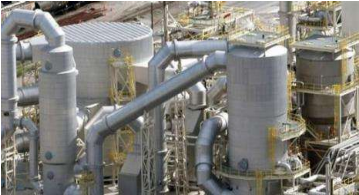
Figura 22. Planta industrial de la empresa DuPont.
