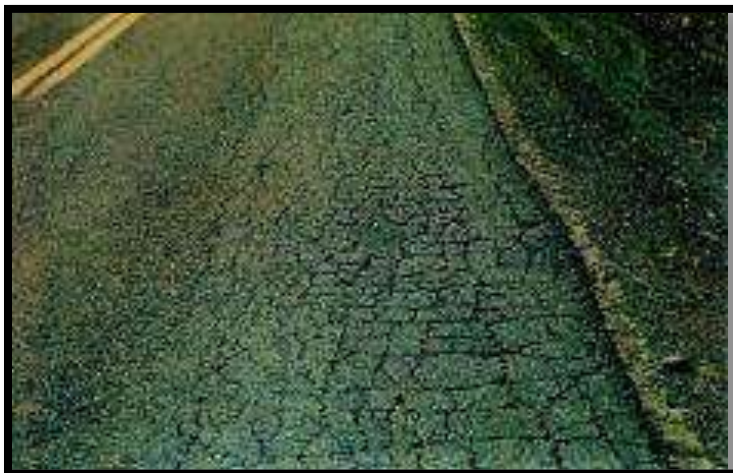
Figura 8. Pavimento asfáltico que presenta agrietamiento por fatiga (Garnica, 2005).
