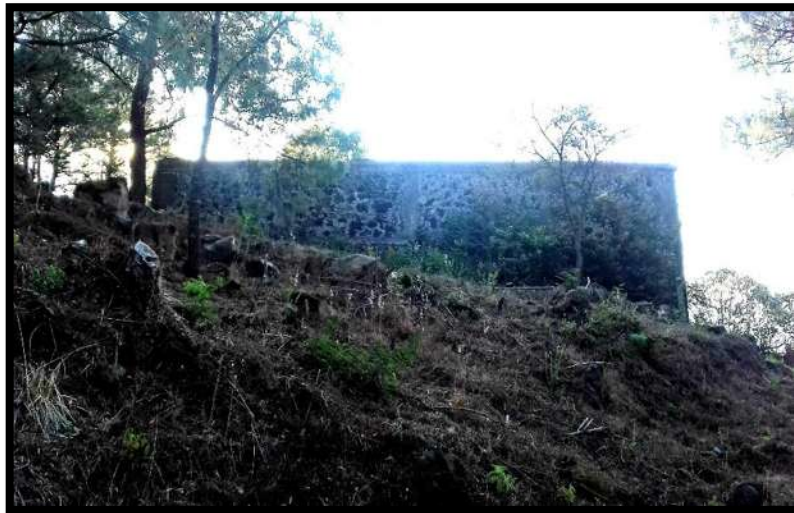
Ilustración 2.23 Vista del tanque de regulación de la red "Altavista", 2017.
