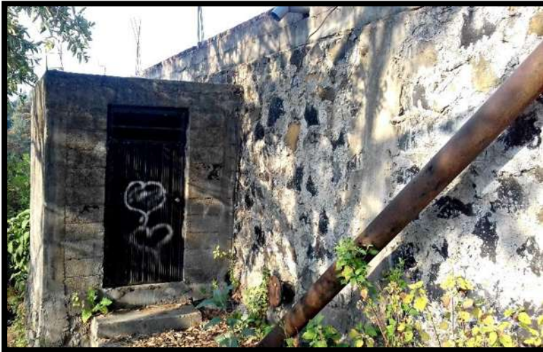
Ilustración 2.26 Grafitis, resultado del vandalismo realizado en el tanque de regulación de la red "Altavista", debido a la poca supervisión y falta de seguridad del perímetro, 2017.
