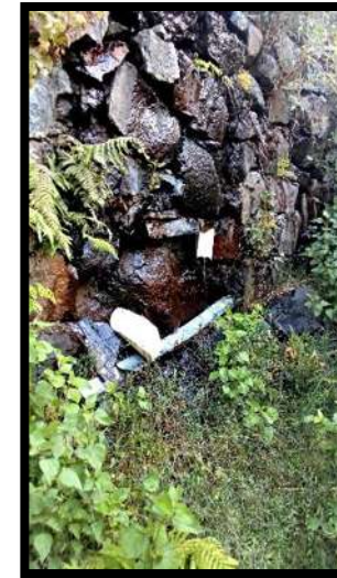
Ilustración 2.25. Acercamiento a una de las fugas visibles a través de la mampostería.
