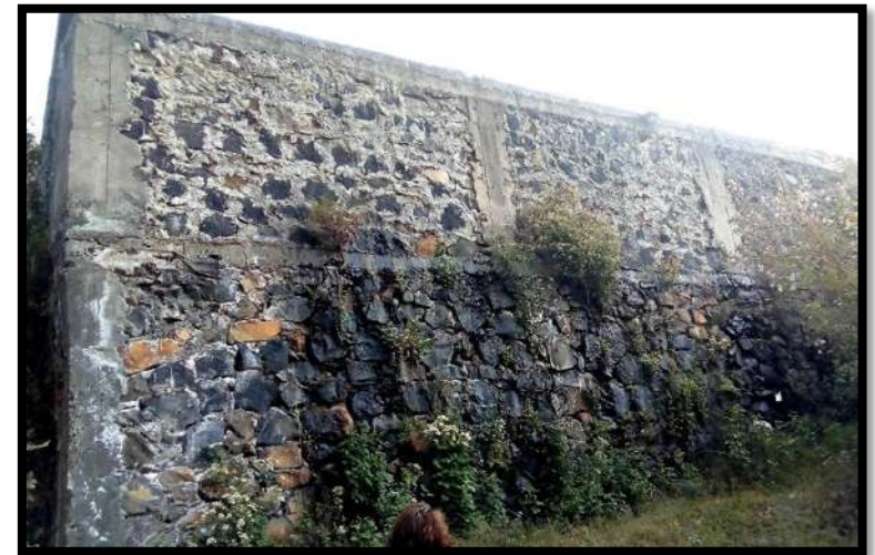
Ilustración 2.234 Se puede apreciar el cambio de color en la mampostería inferior resultado de las diversas fugas que tiene el tanque de regulación de la red "Altavista", 2017
