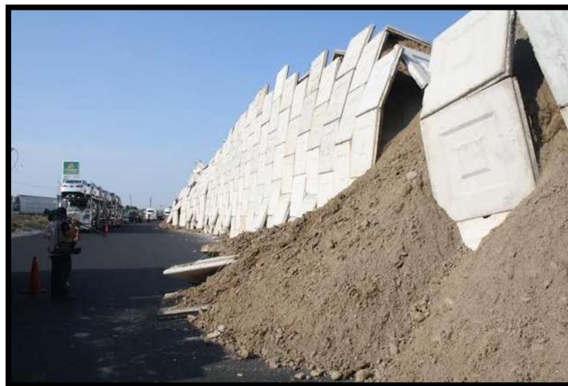
Figura 11 Derrumbe parcial en muro de contención
