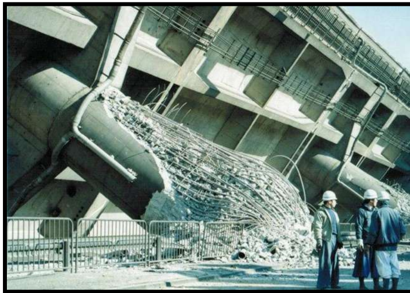
Figura 5 Colapso de 10 tramos de la autopista elevada Hanshin debido a falla por cortante (Sismo de Kobe 1995)
