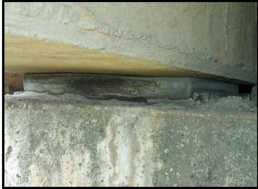
Figura 8 Aplastamiento en apoyo de neopreno
