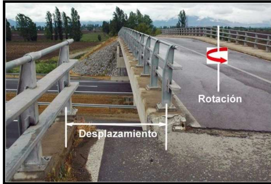
Figura 9 Desplazamiento transversal en puente de concreto, resultado de acciones sísmicas
