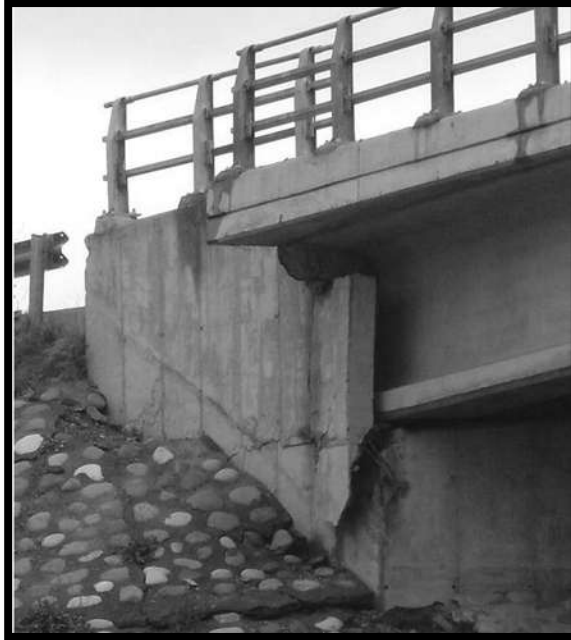
Figura 10 Agrietamiento en el estribo a causa de asentamiento en acceso del puente
