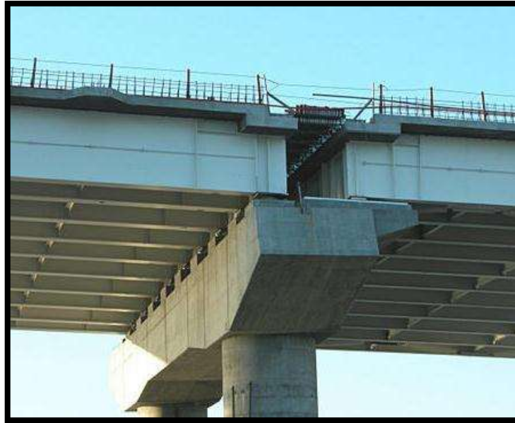
Figura 12 Separación excesiva de una junta de dilatación
