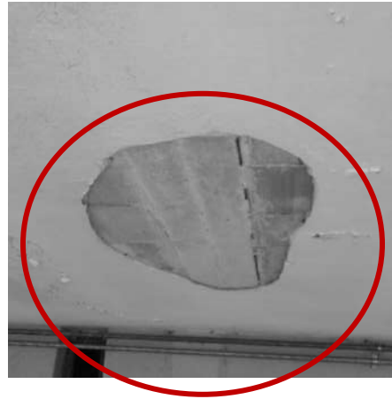
Figura 19. Problemas de humedad observados. (Curso di Vittorio No. 23)
