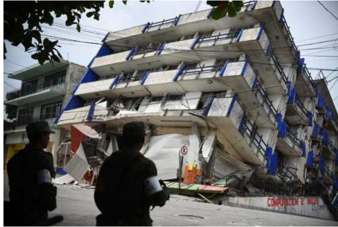
Figura 3. Edificio derrumbado en la ciudad de México, tras el sismo ocurrido el pasado 19 de septiembre del 2017. (Foto: Viviana Zocco).
