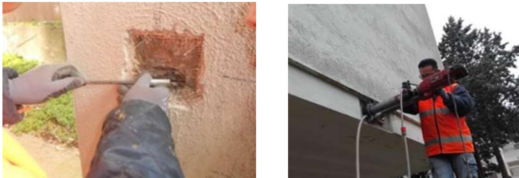
Figura 21. Extracción de cilindros de concreto en vigas y columnas (Corso Di Vittorio No.23).
