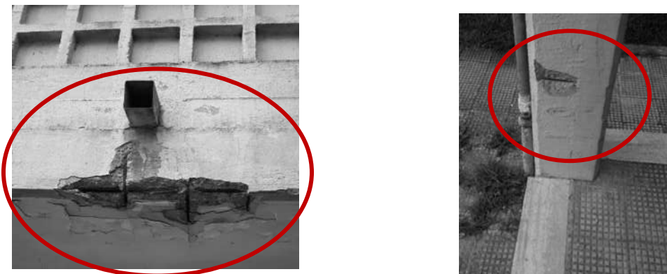
Figura 20. Fisuras presentes en vigas y columnas (Curso di Vittorio No. 23)
