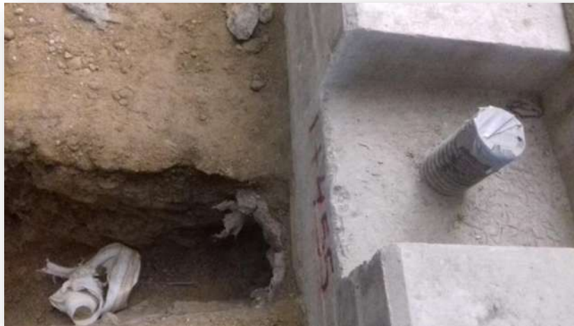
Figura 17.- Base de tormenta de 4 pulgadas terminada y zanja para tubería de boca de tormenta.
