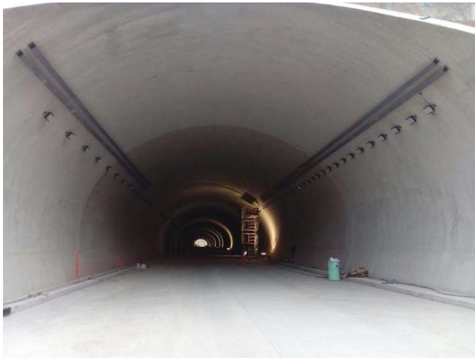
Figura 4.- Iluminación al interior del túnel.
