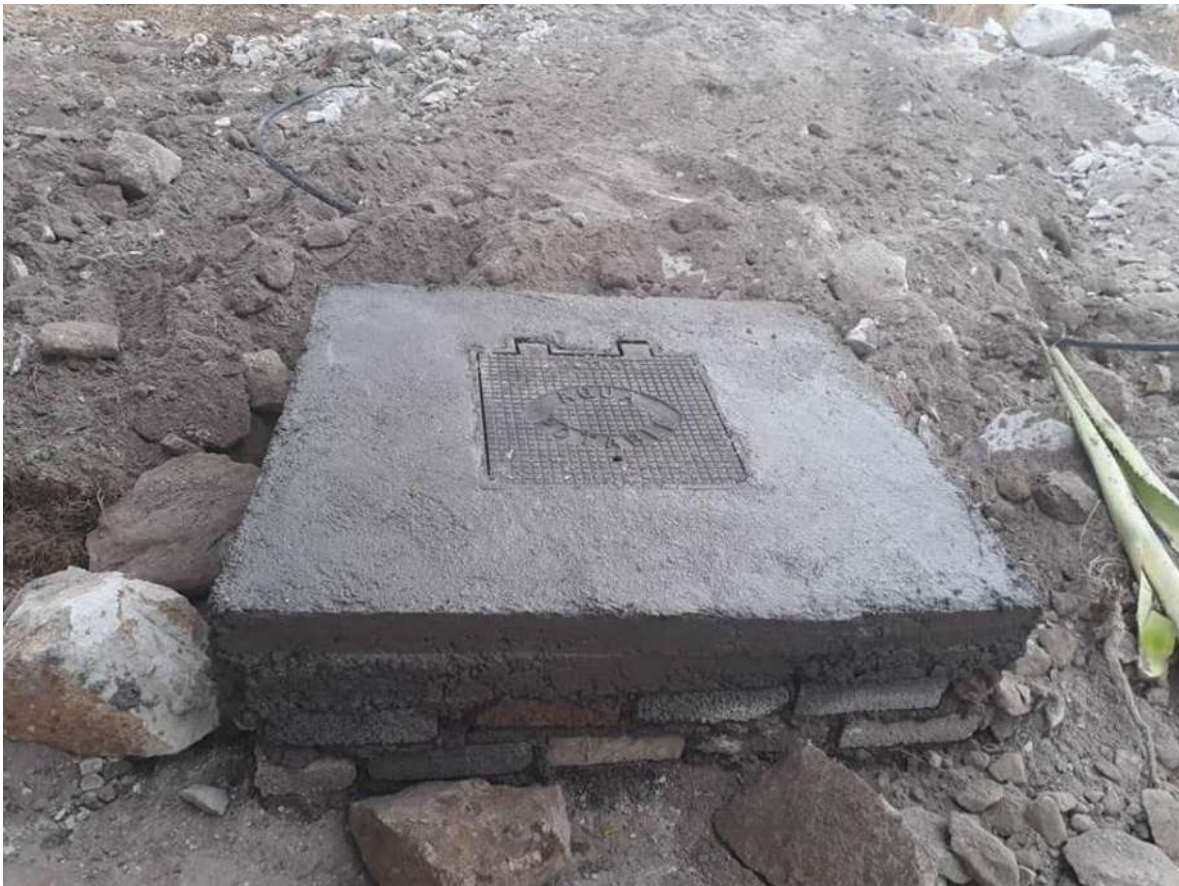
Figura 5.57 Caja de operación de válvulas tipo II
