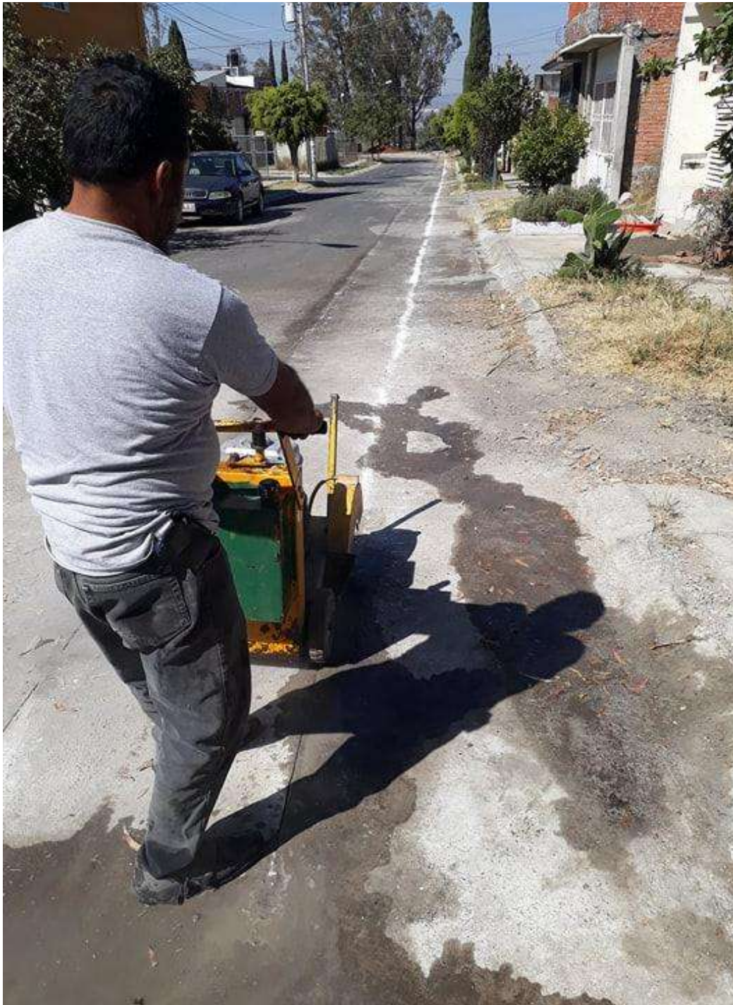
Figura 5.47. Ruptura de carpeta asfáltica.
