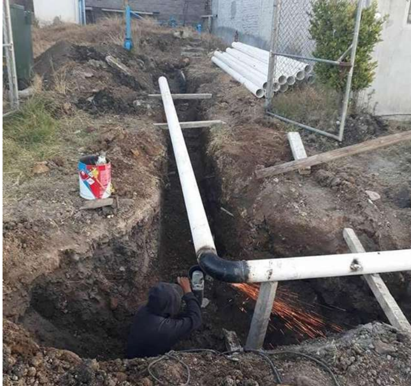
Figura 5.33. Tubería de acero al carbón de 6"Ø cedula 40
