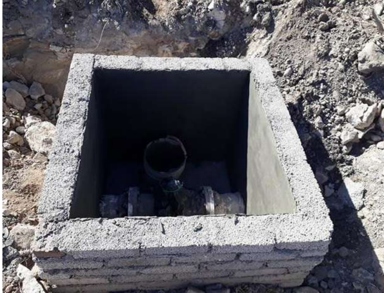
Figura 5.40. Caja de operación de válvulas.
