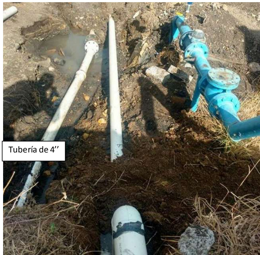
Figura 5.29. Línea de conducción de 4"
