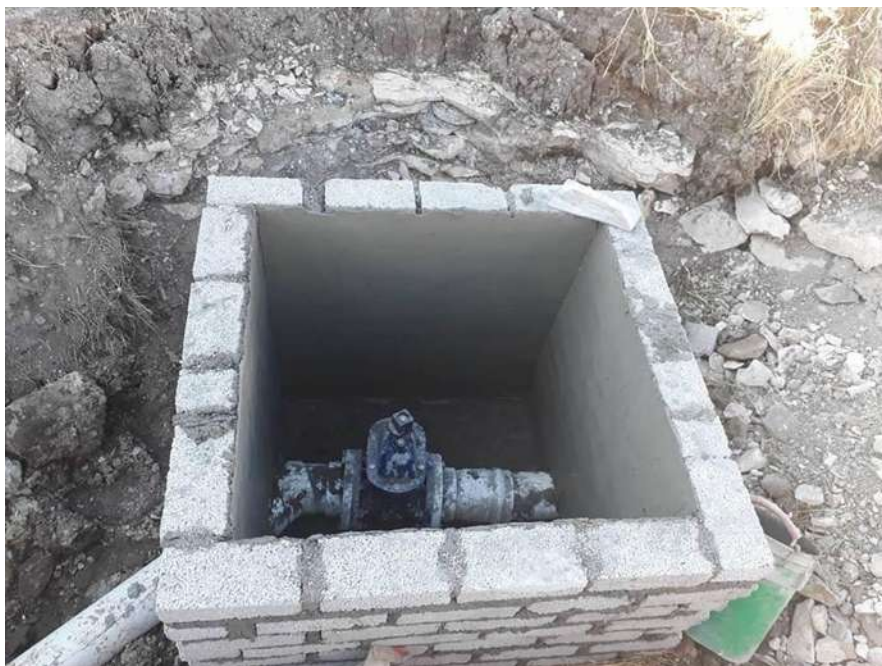
Figura 5.81. Caja de operación de válvulas tipo II.
