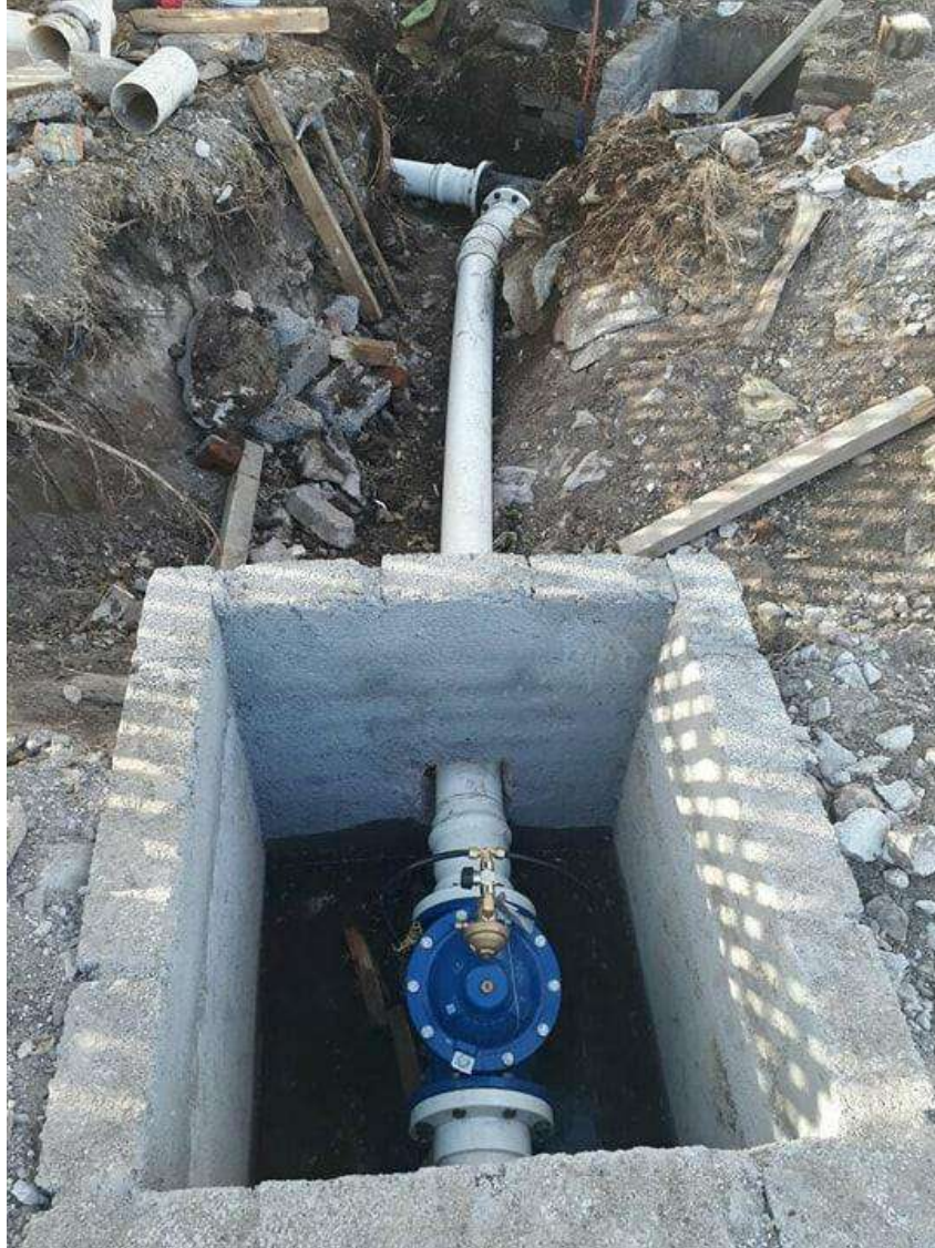
Figura 5.58 Válvula de control tipo on /off de 6”.
