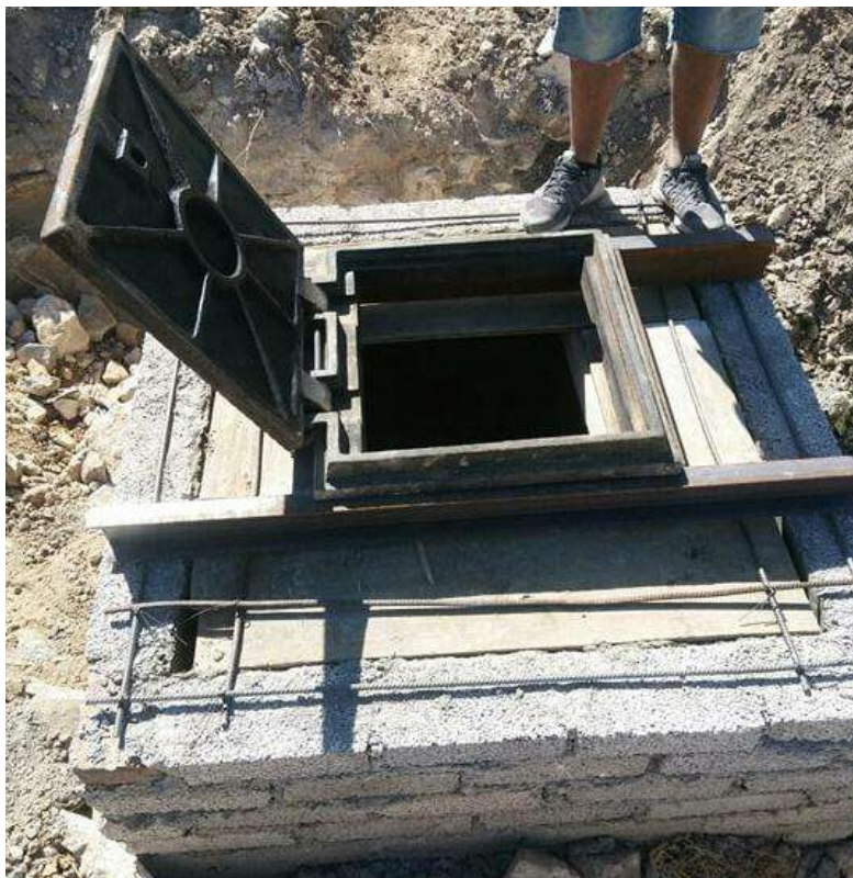
Figura 5.41. Contramarco y tapa de caja de operación de válvulas.
