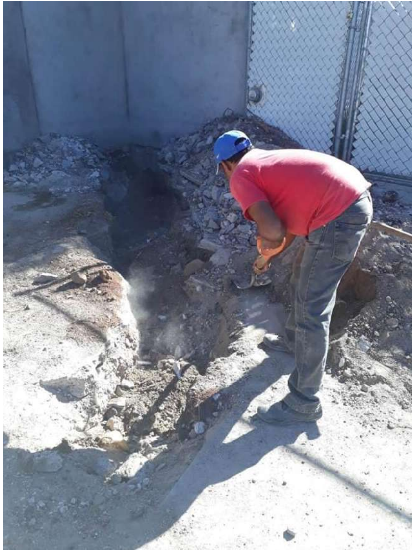
Figura 5.45. Ruptura de banqueta.
