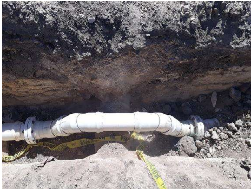
Figura 5.86. BYPASS DE PVC
