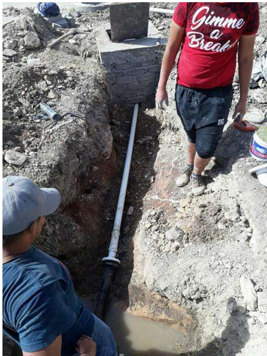
Figura 5.96. Tubería de 2" de diámetro.
