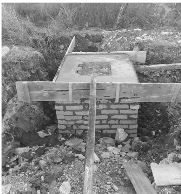
Figura 5.82. Caja de operación de válvulas tipo II.
