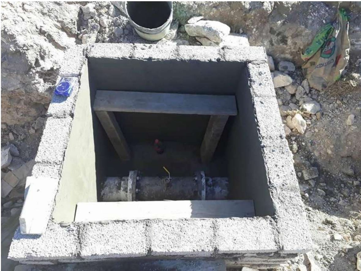
Figura 5.79. Caja de operación de válvulas tipo I
