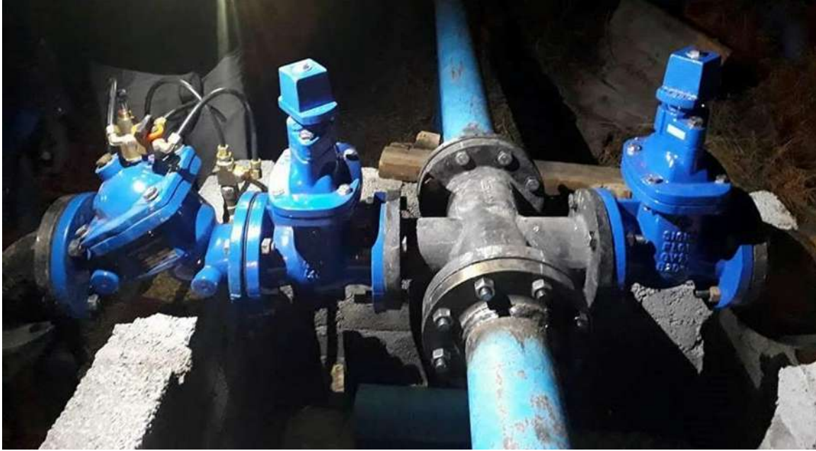
Figura 5.21. Tren de descarga
