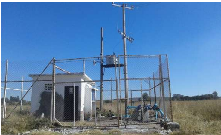
Figura 9. Pozo de Agua Potable
