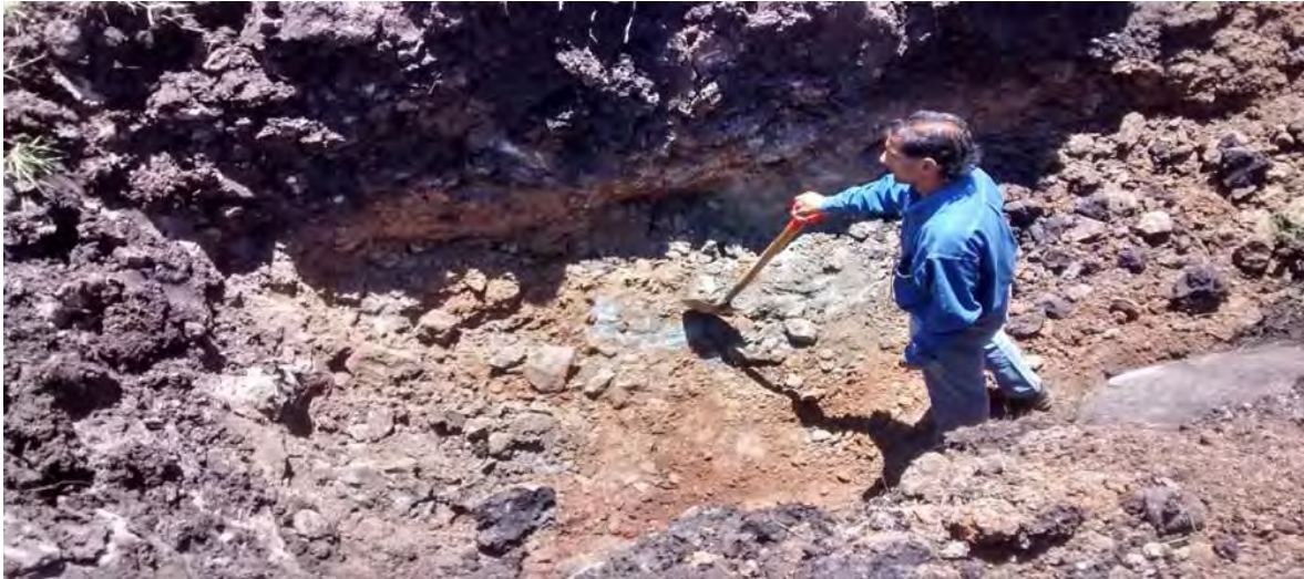
Excavación en nivel de desplante, falta afine de piso.
