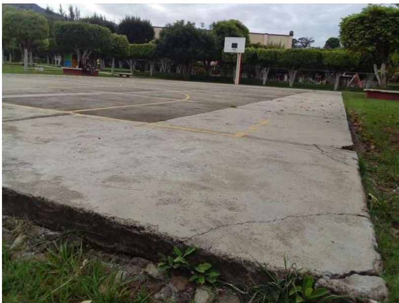
Imagen 5 Estado actual de las canchas
