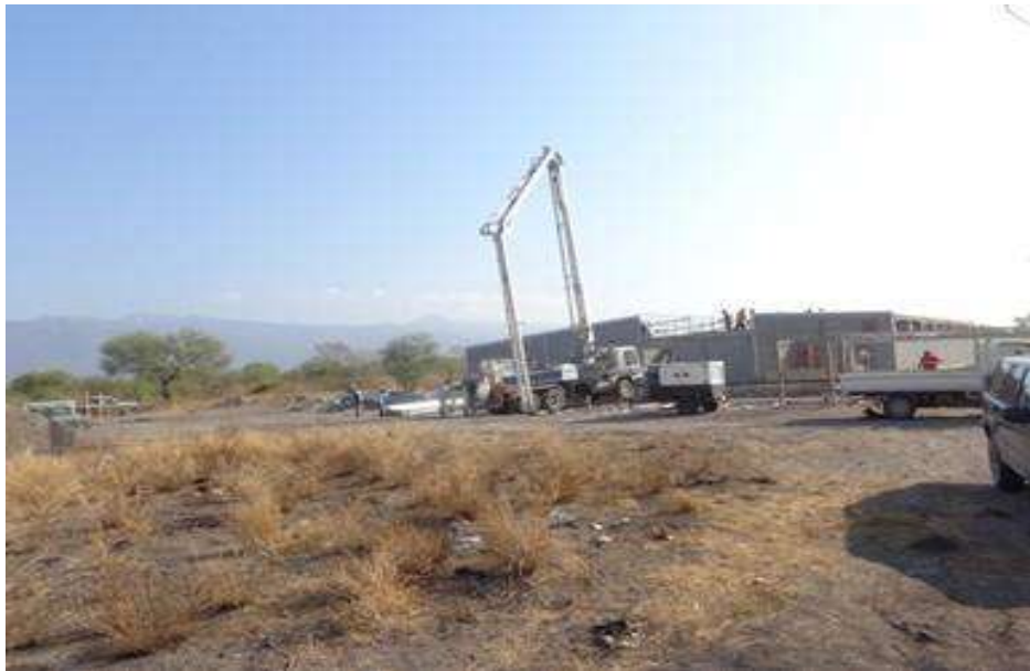
Colocación de concreto f'c=200 kg/cm 2 con un tamaño de agregado de \frac{3}{4} " en losa de entresuelo.
