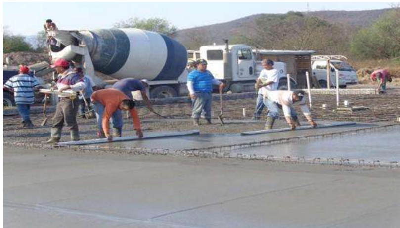
Colocación del concreto f'c=150 kg/cm 2 y un tamaño de agregado de \frac{3}{4} " para losa de cimentación y dala.
