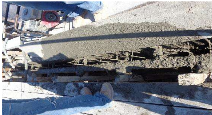
Colocación de concreto f'c=250 kg/cm 2 , con agregado \frac{3}{4} ", con varilla del #3 a @ 15 cm en zapatas.
