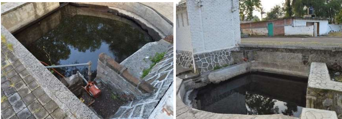
Fig. 4.2 – 4.3 Equipo de bombeo. Fuente: Marisa Anguiano. 2017
