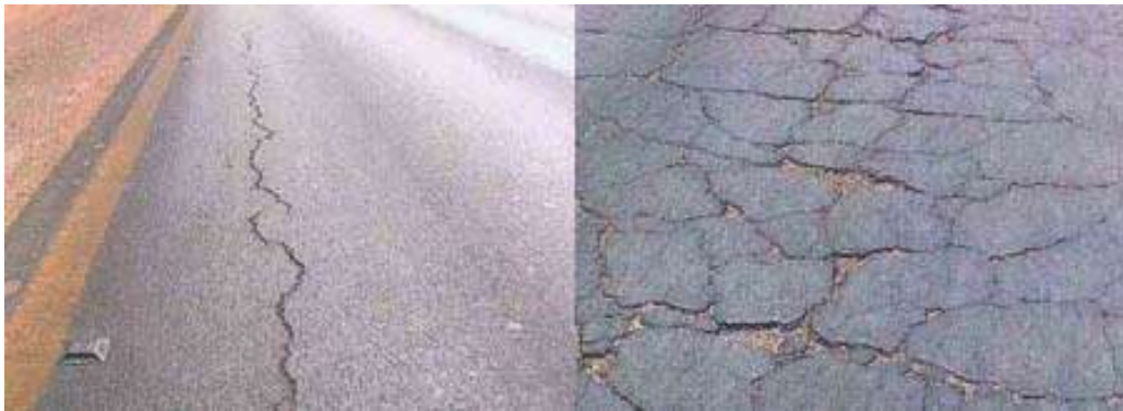
Figura 1. 4 Agrietamiento por fatiga
