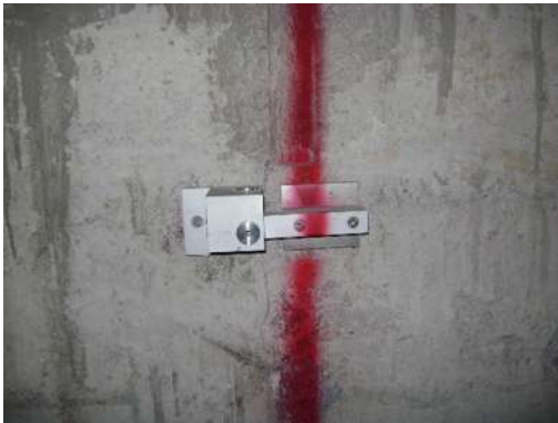
Foto 3. IV.3.4 Vista de frente del medidor de juntas triortogonal colocado.
