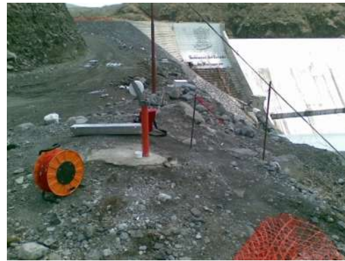
Foto 6. IV.3.5 Vista del inclinómetro colocado.
