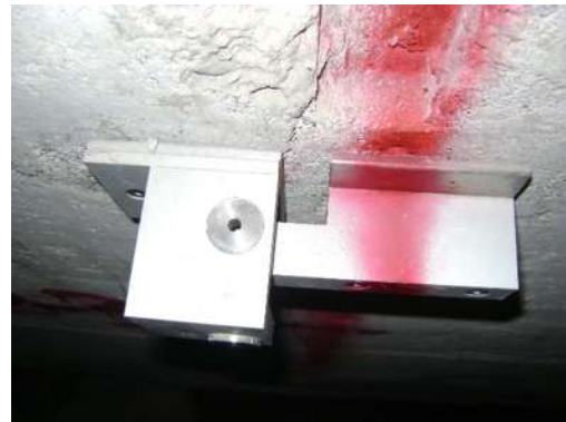
Foto 4. IV.3.4 Vista lateral del medidor de juntas triortogonal colocado.
