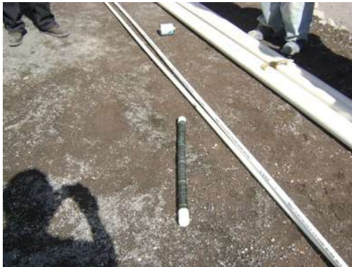
Foto 4. IV.3.6 Vista del bulbo y la tubería.
