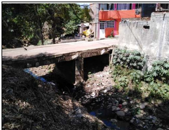
FIGURA 4-14 FOTOGRAFÍA REAL, SECCIÓN TRANSVERSAL DEL PUENTE #4 DESPUÉS DE LA INUNDACIÓN.
