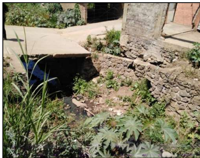
FIGURA 4-12 FOTOGRAFÍA REAL, SECCIÓN TRANSVERSAL DEL PUENTE #3 DESPUÉS DE LA INUNDACIÓN.
