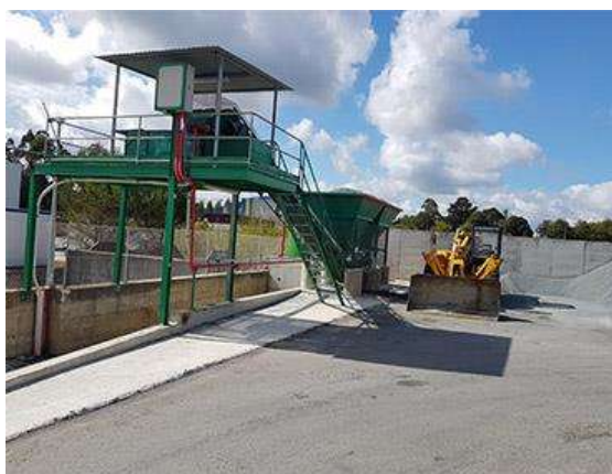
FIGURA 6. - PLANTA ASFÁLTICA EN FRÍO (QUIMIASFALT,2019) [10/07/2019]
