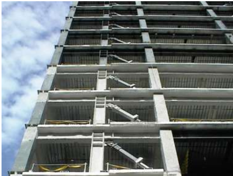
Figura 70: Amortiguadores sísmicos colocados en diagonal en el edificio de la sede budista en Taipéi, Taiwán (Fuente: Taylor Devices Inc 2002)
