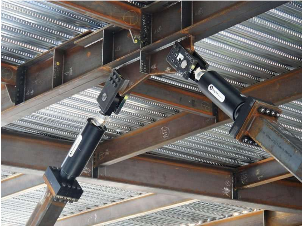
Figura 71: Amortiguadores sísmicos en diagonal colocados en el palacio de justicia en San Bernardino, California (Fuente: Taylor Devices Inc 2012)
