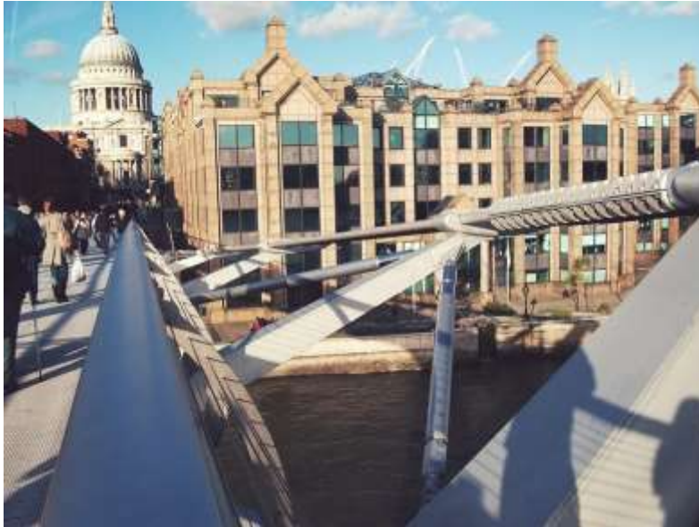
Figura 69: Amortiguadores de control en el puente “Millennium” en Londres (Fuente: Taylor Devices Inc 2001)
