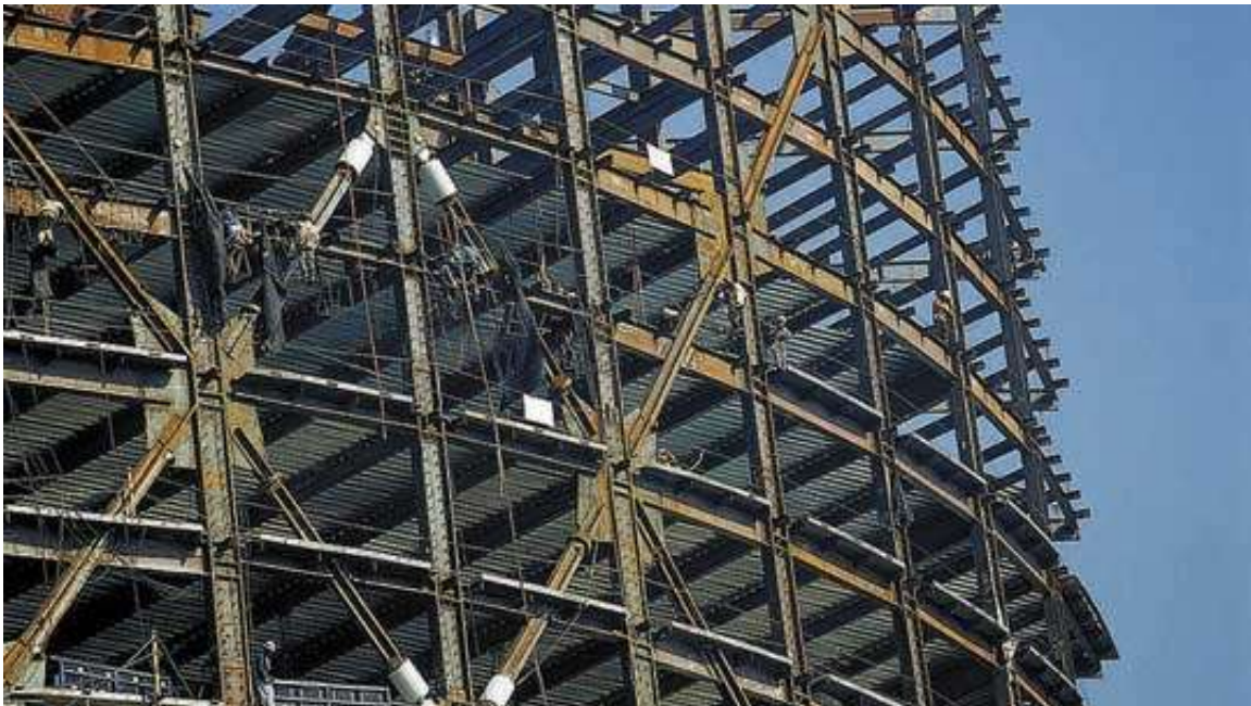
Figura 68: Amortiguadores de fluido viscoso instalados en la construcción de la estructura de la Torre Mayor (Fuente: Pin Molina 2018)
