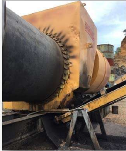
Figura 4.3.11 Extractor de polvos de la planta asfáltica. Fuente: Elaboración propia
