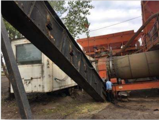
Figura 4.3.33 Elevador transportador de material. Fuente: Elaboración propia
