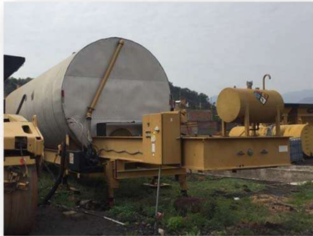
Figura 5.1.12 Tanque de almacenamiento para cemento asfáltico. Fuente: Elaboración propia.
