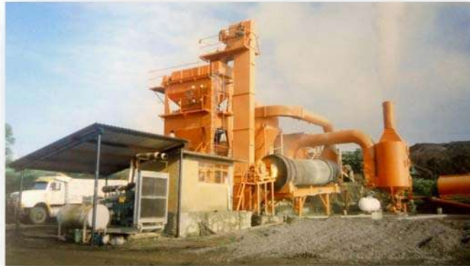
Figura 4.3.4 Planta asfáltica estacionaria dosificadora. Fuente: Pavimentos Asfálticos Tres Marías S.A. de C.V.
