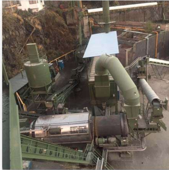
Figura 4.3.25 Mezclador de tambor "Double Barrel" en la planta asfáltica de la ciudad de México. Fuente: Elaboración propia
