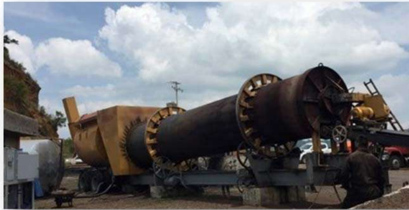
Figura 4.3.9 Tambor mezclador de planta asfáltica. Fuente: Elaboración propia
