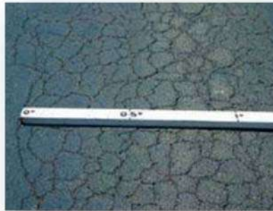
Figura 2.1.4 Agrietamiento en piel de cocodrilo en un pavimento asfáltico.
