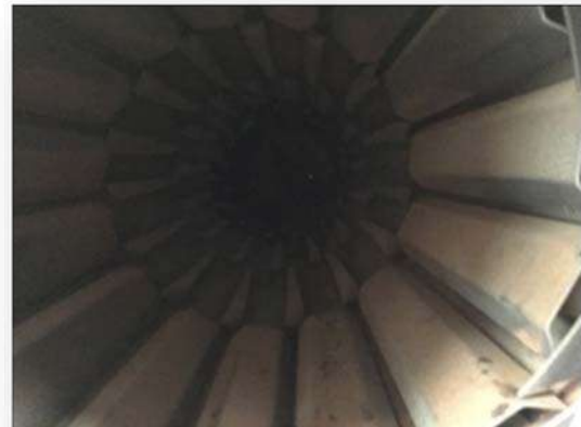
Figura 5.1.6 Alabes dentro del tambor de la planta asfáltica. Fuente: Elaboración propia
