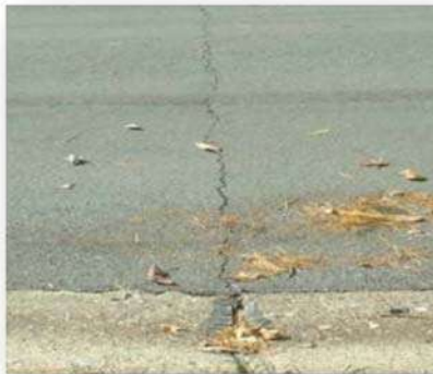
Figura 2.1.7 Agrietamiento transversal en un pavimento asfáltico. Fuente: www.flynnbrothers.com
