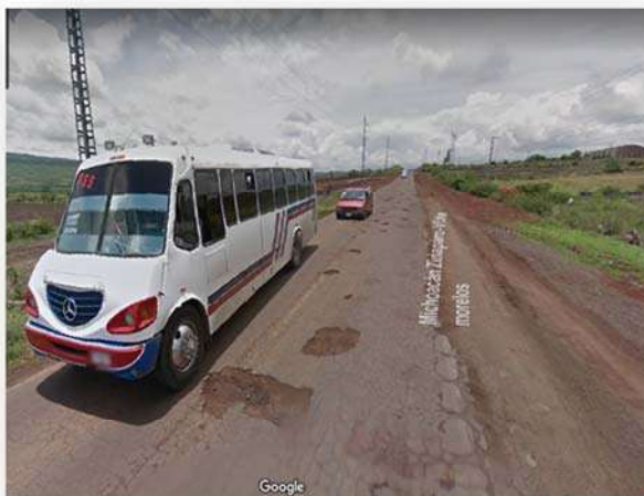
Figura 5.3.1.3 Tramo con pavimento dañado. Fuente: www.googlemaps.com
