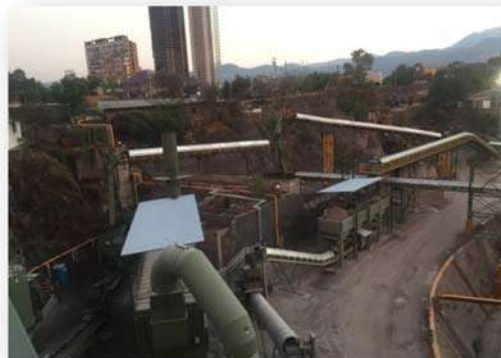
Figura 4.3.30 Componentes de la planta de asfalto. Fuente: Elaboración propia
