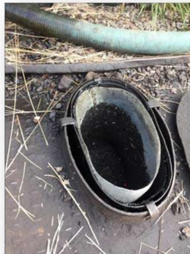
Figura 4.3.37 Colador de residuos en la entrada de los tanques. Fuente: Elaboración propia
