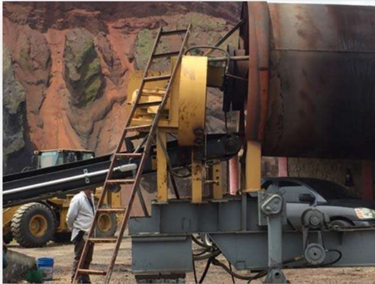
Figura 4.3.13 Quemador de la planta asfáltica. Fuente: Elaboración propia
