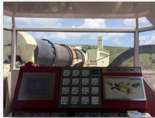
Figura 4.3.22 Cabina de control. Fuente: Elaboración propia
