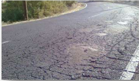
Figura 2.1.1 Agrietamiento por baja temperatura. Fuente: Manuel Tinoco Zamudio, Historia y evolución de las mezclas asfálticas en las carreteras de México.
