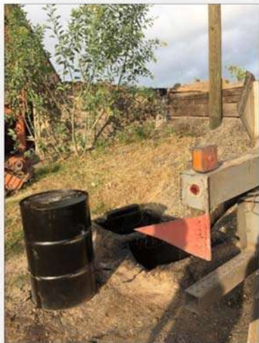
Figura 4.3.36 Tanques de almacenamiento enterrados. Fuente: Elaboración propia
