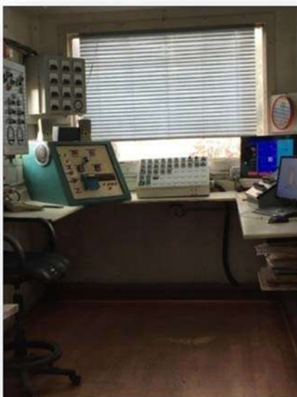
Figura 4.3.41 Interior de la cabina de control. Fuente: Elaboración propia
