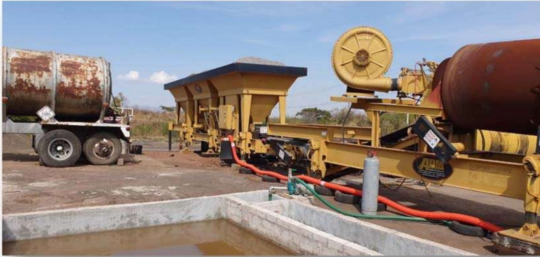
Figura 5.3.3.11 tanque de almacenamiento Fuente: Elaboración propia
