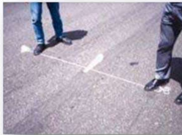
Figura 2.1.8 Hundimiento de la superficie de un pavimento asfáltico. Fuente: Bobby David Barnes, Airfield Pavement Maintenance Manual.
