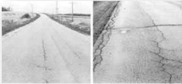
Figura 2.1.6 Agrietamiento longitudinal en un pavimento asfáltico. Fuente: www.hardinpaving.com
