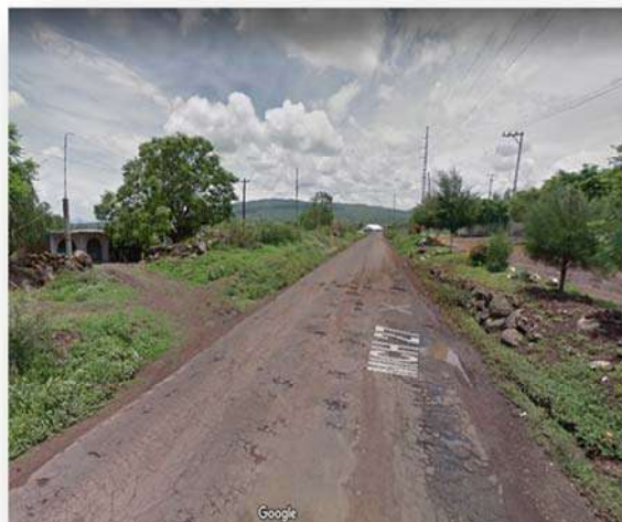
Figura 5.3.1.4 Tramo con pavimento dañado. Fuente: www.googlemaps.com
