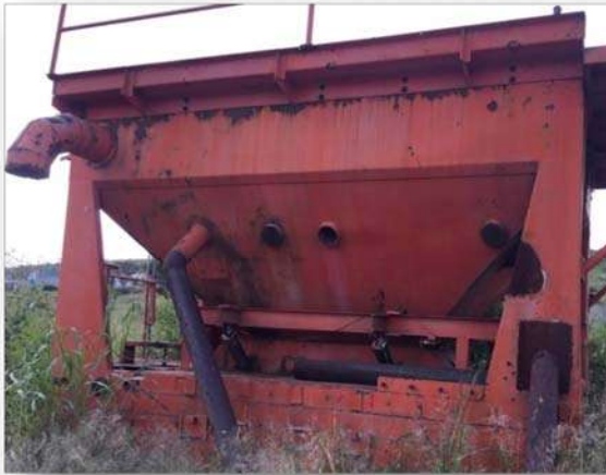
Figura 4.3.6 Tolva de almacenamiento de agregados pétreos. Fuente: Elaboración propia
