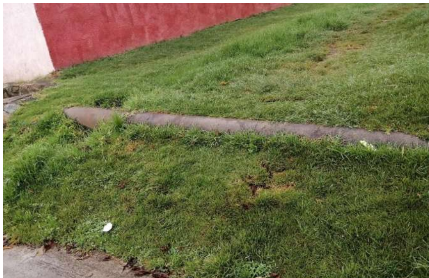
Figura: 4. 2. Tubería de red de alcantarillado sanitario (red de alcantarillado) en el municipio de Zurumbeneo.
